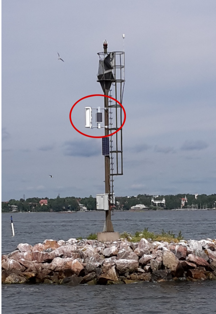
Kuva 3: Neljänviitankarin tuuliturbiinin uusi räätälöity metallinen asennus. Samaan kiinnitykseen on asennettu myös aurinkopaneeli. Kuva: Jan-Victor Björkqvist
