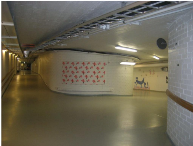
Tunneli N-rakennuksen (vas.) ja väestönsuojan välissä. Vasen tunneli johtaa kadun toisella puolella olleen pesularakennuksen suuntaan.
