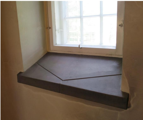
Ikkunapenkki, johon on uurrettu kondenssivesiurat ajan tavalliseen tapaan.
