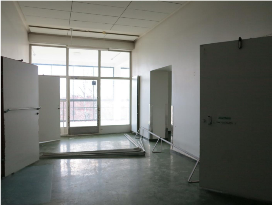
Vuonna 1968 erkkerin paikalle tehty lasiseinä kaakkoispäädyn uudelle parvekkeelle.
