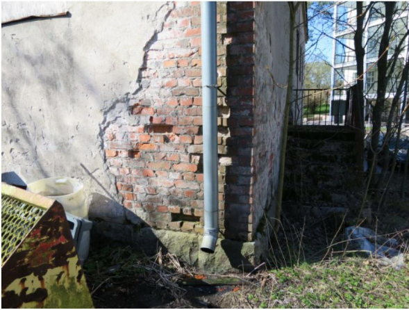
Vuotaneiden syöksytorvien vahingoittamaa alkuperäistä rappaus- usta ja muurausta.
