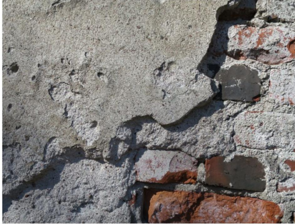
Jäätäneet vuotovedet vahingoittaneet jopa tiilimurausta. Missä vuotovesiä ei ole ollut, on jopa alkuperäinen rappaus hyvässä kunnossa.
