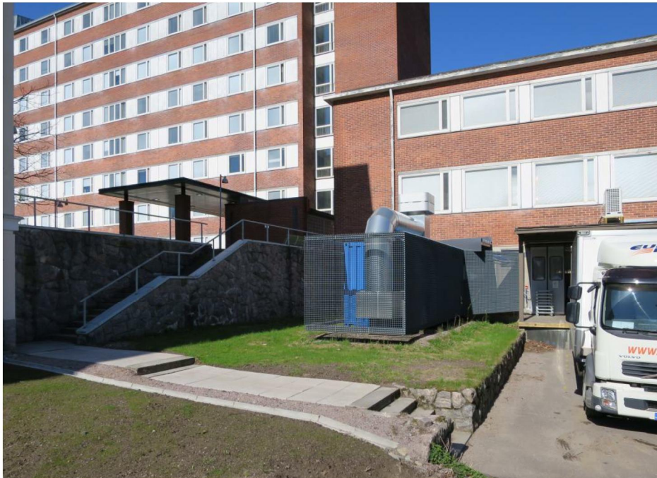
Vuonna 2010 asennettu uusi ilmanvaihto-kontti.
