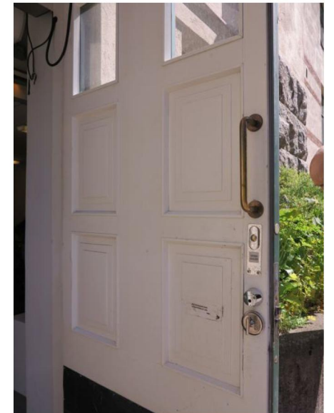
A-portaan vanhaan tyyliin uusittu, kunnostuksen tarpeessa oleva ulko-ovi.
