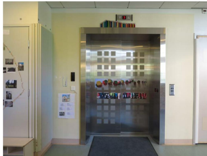
2. kerroksen kerroshallissa, uuden hissin EI60 osastoidut ovet ja pielet ovat hiottua rst-levyä.
