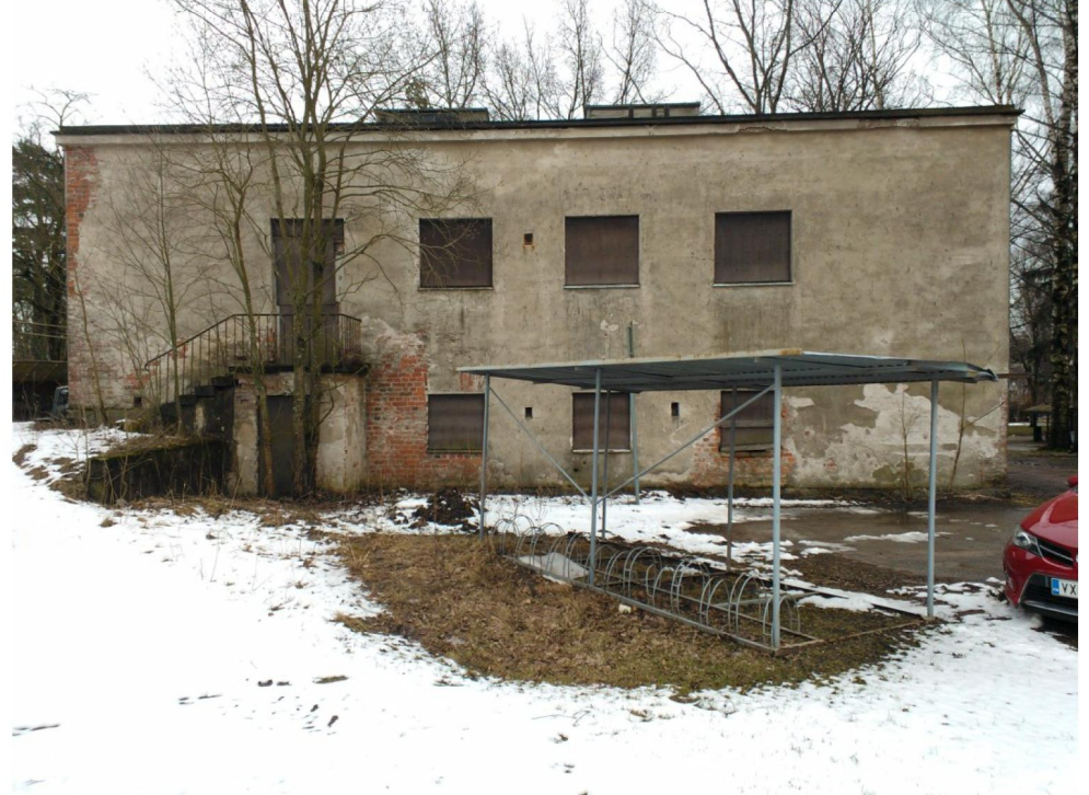
Saunan luoteinen julkisivu. Ovet ja ikkunat on levytetty vanerilla.
