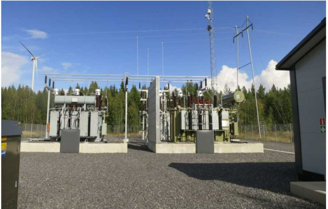
Kuva 2-6. Tyypillinen noin 34 MW:n tuulipuistoa varten rakennettu kahden päämuuntajan muuntoasema, jossa tuulivoimaloiden tuottama sähköenergia muunnetaan keskijännitteisestä 110 kV:n suurjännitteelle. Tuulivoimalat on liitetty keskijännitemaakaapelein sähköaseman keskijännitekojeistoon, joka sijaitsee kuvan oikeassa reunassa näkyvässä rakennuksessa. Liittymispisteenä toimii tässä tapauksessa 110 kV:n ilmajohto. (Kuva: Petri Niemi / Pöyry)
