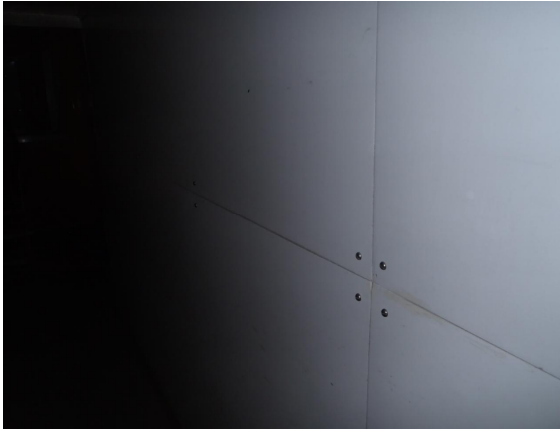
Kuva 2. Näyte M3. 1. kerroksen käytävän seinässä on kuitusementtilevviä, jotka sisältävät asbestia .
