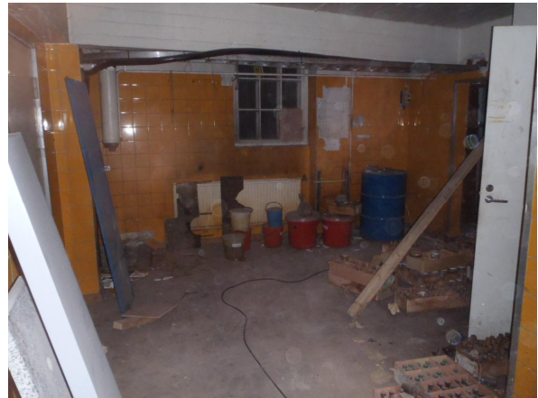
Kuva 5. Oranssin keraamisen laatan saumalaasti sisältää asbestia .
