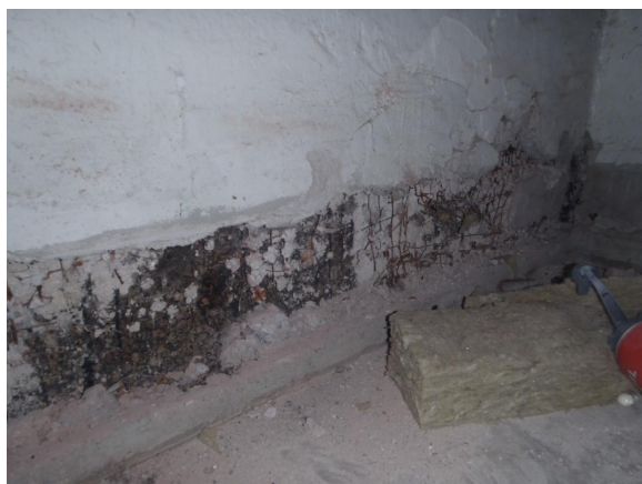
Kuva 7. Seinien alaosissa oleva korkieristys on kiinnitetty PAH-yhdistepitoisella bitumisivelyllä.
