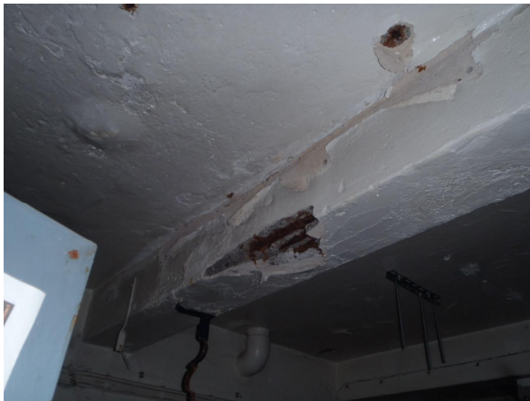
Kuva 9. Kattopalkin pääteräkset ovat pahoin ruostuneet.
