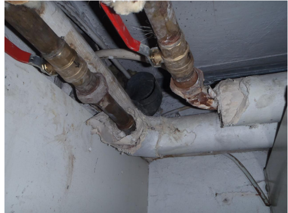
Kuva 3. Kiinteistön vanhat putkieristeet sisältävät asbestia . Asbestia on sekä eristyksen ulkopinnassa olevassa valkoisessa silotemassassa että mutka- ja liitoskohdissa olevassa piimaa-massassa.
