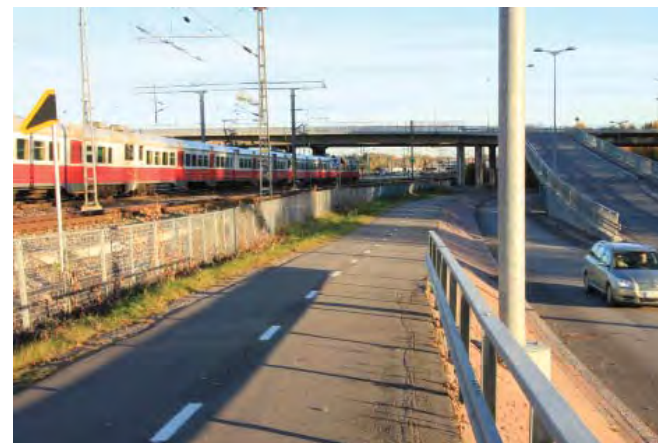
Paaluvälillä 795 - 980 kaiteettomuus aiheuttaa suistumisriskin alas Ratapihantien ajoradalle.
