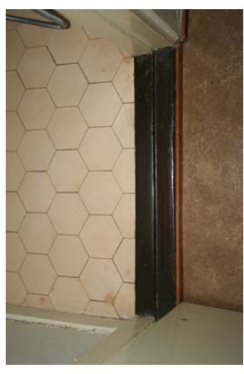
KUVA 82: Erillis-wc:n vanha lattia, 2011
