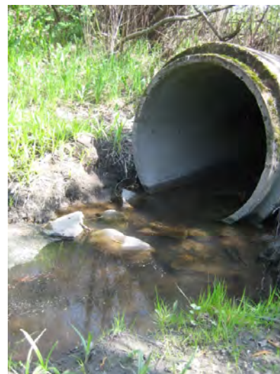
Kuva 17. Torpparinmäen hulevesiviemäri. Kuva: Katja Pellikka.
