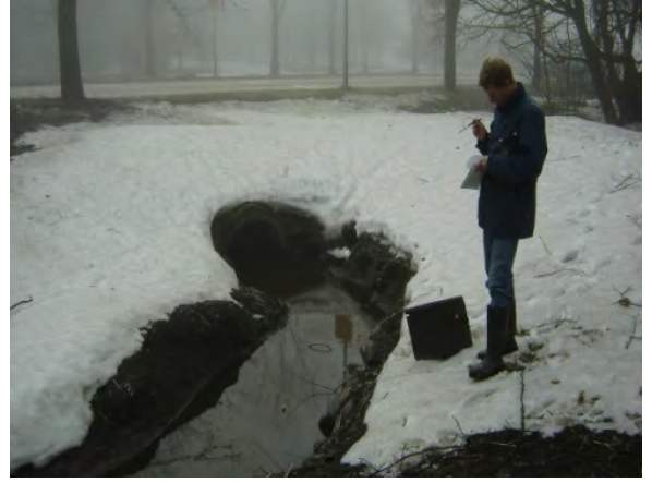
Kuva 13. Lauttasaaren hulevesiviemäri. Kuva: Paula Nurmi.
