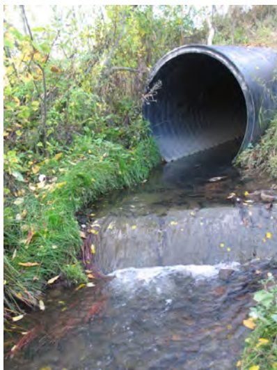
Kuva 16. Ala-Malminojan hulevesiviemäri. Kuva: Katja Pellikka.
