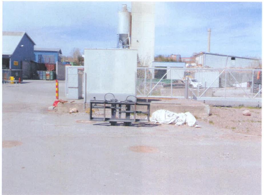
Kuva 7. Sähkökeskus ja pumppaamo. Etualalla hiekan- ja öljynerotinkaivojen kannet.
