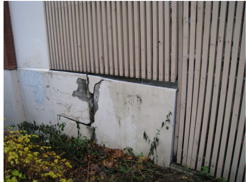
KATKENNEET TUKIMUURIT VAURIOITTAVAT MYÖS AITOJA
