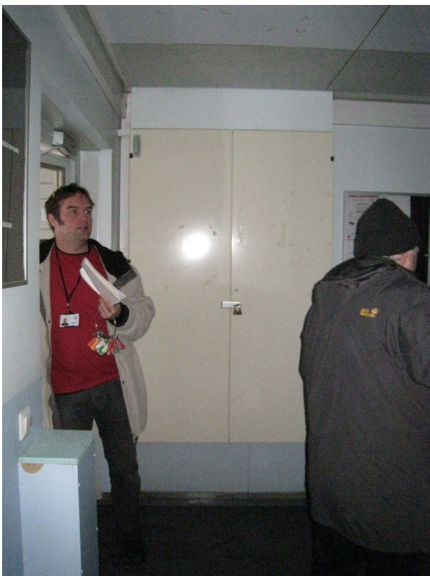
PORRASHUONEEN OSASTOIMATON SÄHKÖKESKUS
