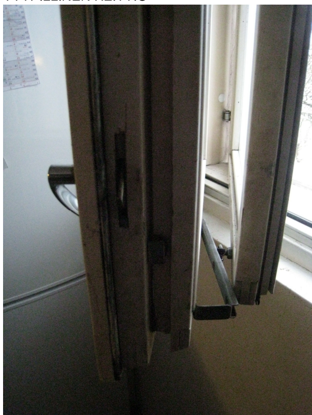
TUULETUSPUITTEIDEN HELOISSA ONGELMIA
