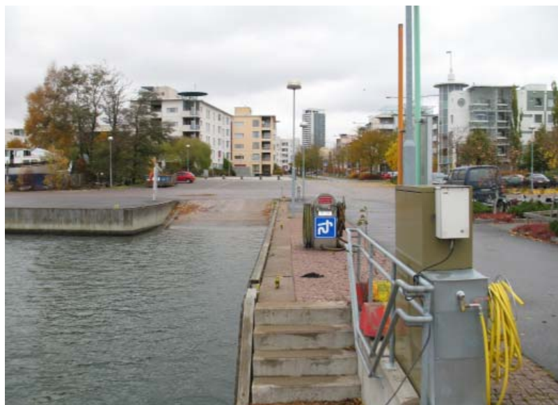
Kuva 23. Septitankin sekä pilssiveden imutyhjennyslaitteisto Kalkkihiekantorilla.
