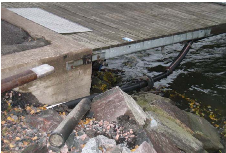
Kuva 20. Septitankin ja pilssiveden imutyhjennyslait- teiston putkistoa.
