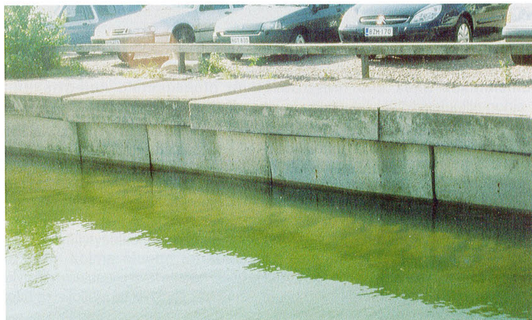
Kuva 16. Eräiden alueiden rannan rakenteiden heikko kunto rajoittaa kuitenkin nostettavien veneiden ja nostossa käytettävän kaluston kokoa. Pajalahden venesatama. Kuva H. Airola.
