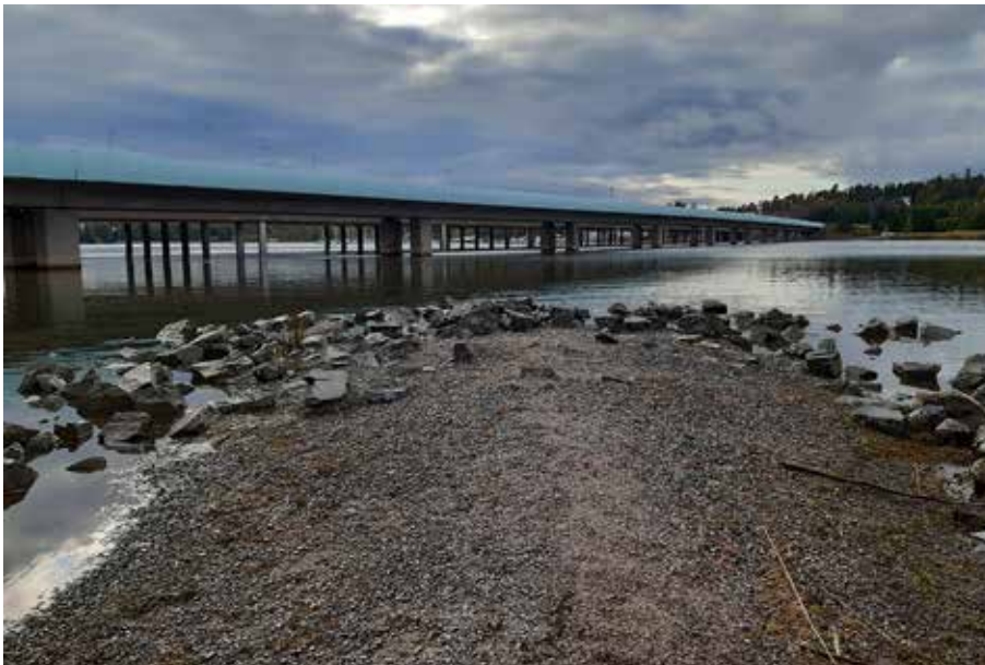
Kuva 101. Uimarantaa suojaava aallonmurtajan kivipenkereet ovat hajonneet.
