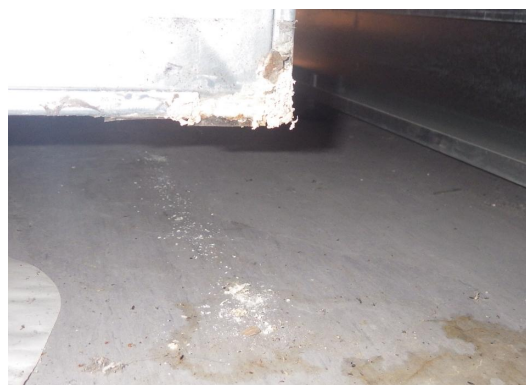
Kuva 11. Tuloilmakoneella oli jälkiä kosteusrasituksesta (raitisilmakammio, suodatinosa).
