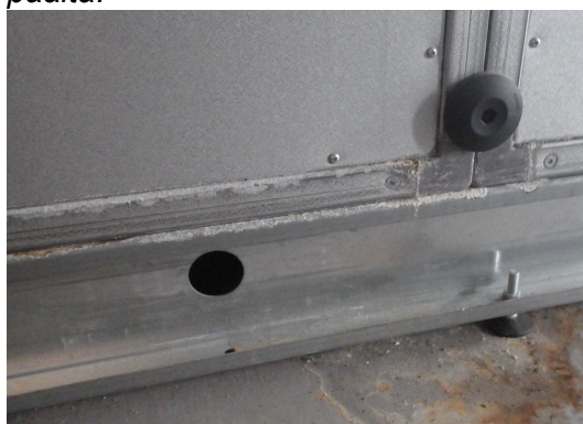
Kuva 10. Tuloilmakoneella oli jälkiä kosteusrasituksesta (raitisilmakammio, suodatinosa).
