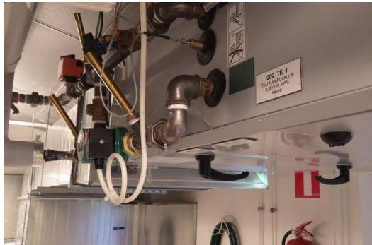
Kuva 4. Keittiön tuloilmakone TK202 on asennettu konehuoneen kattoon.
