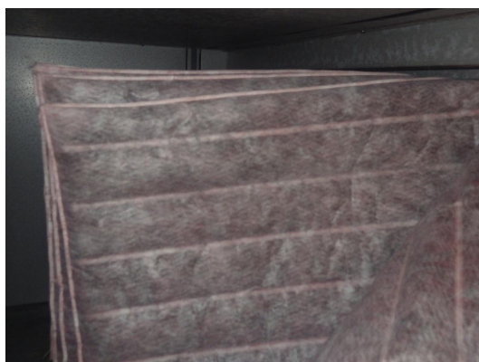
Kuva 6. Tuloilmasuodattimet olivat likaiset.
