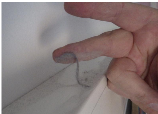
Kuva 12. Huonepölyä sähkökourun päällä tv-huoneessa.
