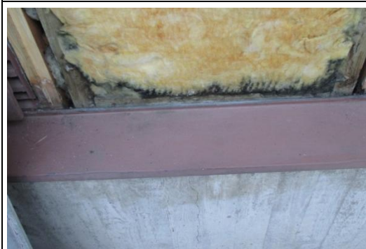
Kotelorakenteen alapuoleisia kosteusjälkiä
