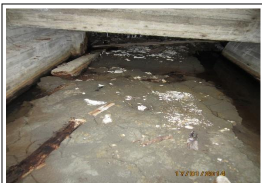
Orgaanista ainesta sekä kosteusvaurioita ryömintätilassa
