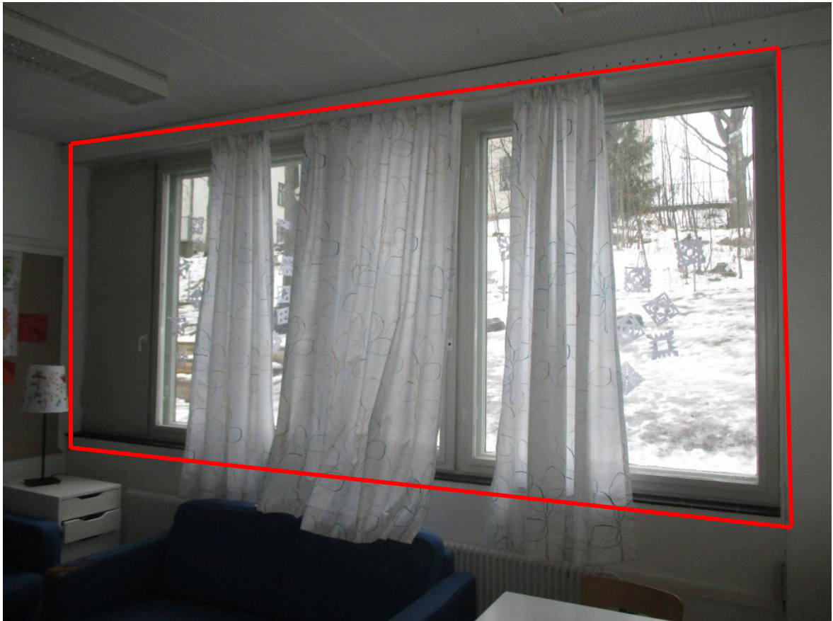
Ikkunan liittymät: Huomattava vuoto
