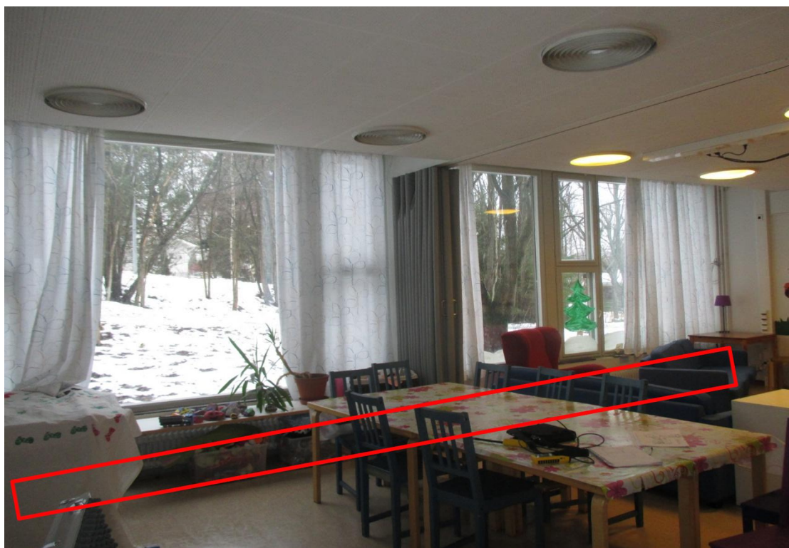
Alapohjan ja ulkoseinän liittymät: Lievä vuoto
