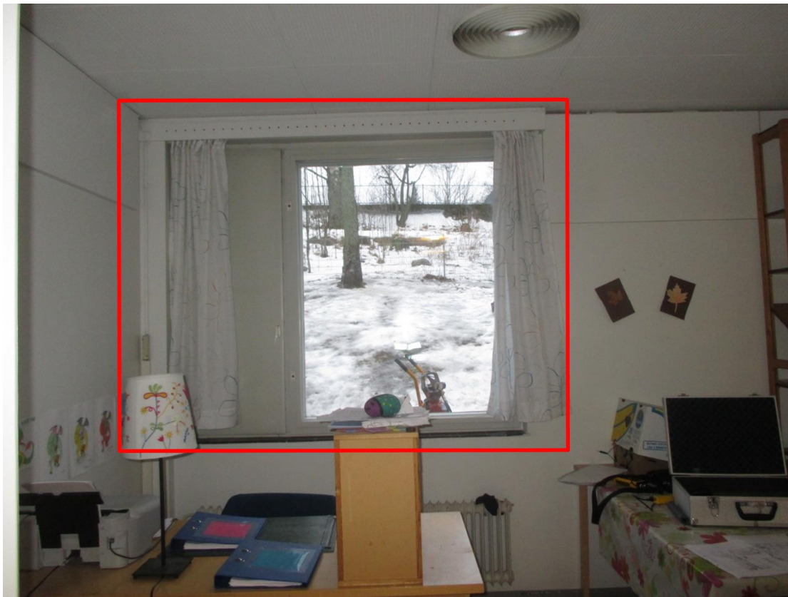
Ikkunan liittymät: Huomattava vuoto
