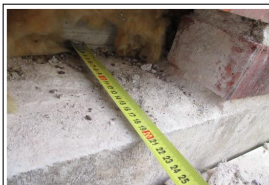
Sokkelin liittymä, ei vedenpoistavaa rakennetta, esim. bitumikermi
