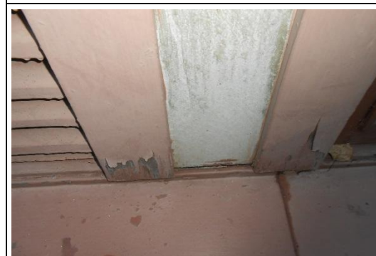
Ikkunoiden ulkopuoleista kulumaa
