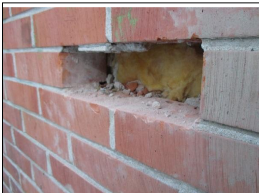
Ulkoseinärakenteen avaus, puutteellinen tuuletusväli
