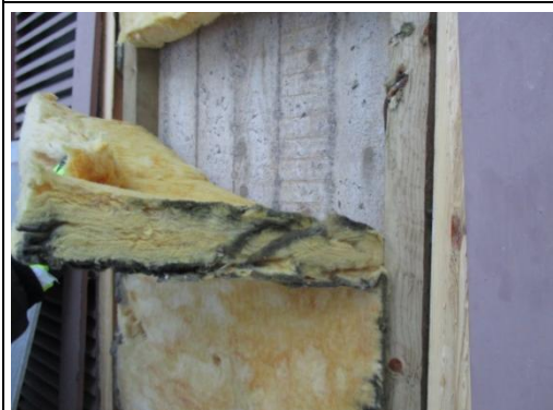
Pilarirakenne, lämmöneristeen kosteusjälkiä
