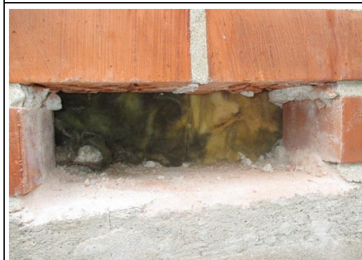
Palkin ja ulkoseinän liittymä, ei vedenpoistavaa rakennetta esim. bitumikermi, lisäksi kosteusjälkiä
