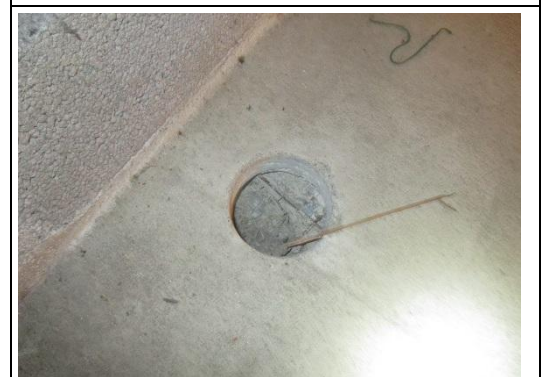
vanhoja paikkaamattomia rakenneavauksia
