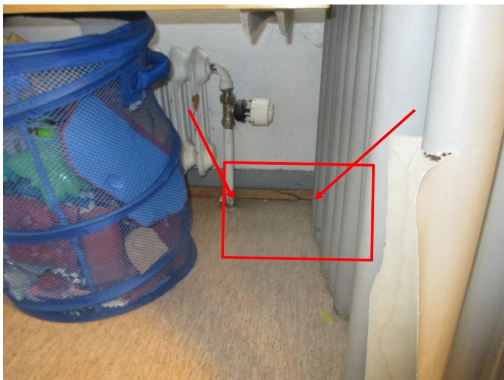
Alapohjan lämpöjohtoläpiviennit sekä pilarin liittymät: Huomattava vuoto
