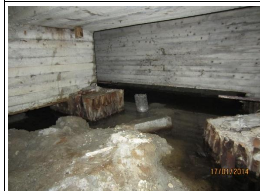
Huomattavasti vettä alapohjatilassa
