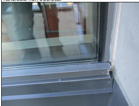
Kuva 5.19. Ikkunalistaa ei ole tiivistetty ulkoseinään
