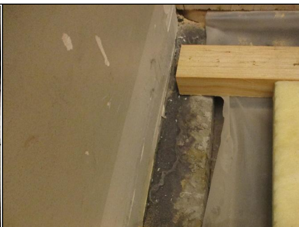
Kuva 5.4. Liikuntasalin lattia tuulettuu listojen kautta sisäilmaan. Reuna-alueilla havaittiin runsaasti pölyä ja likaa.
