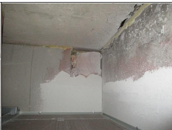
Kuva 5.14. Rakenteiden liitoskohdissa on, aistinvaraisesti arvioiden, epätiiveyskohtia.
