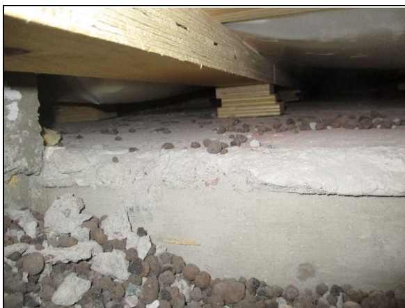
Kuva 5.3. Liikuntasalin lattia ei ole koolattu ristiin. Koolaukset lepäävät vanerikappaleiden päällä.
