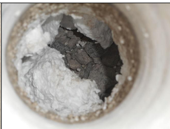
Kuva 5.6. Alapohjarakenteiden alapuolinen maatayttö on vajonnut ja EPS-eristeen ja karkean maa-aineksen välissä on 70 mm ilmatila.
