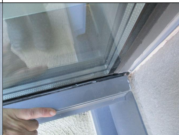
Kuva 5.20. Listan tiivisteiden ja lasin välissä on rako.
