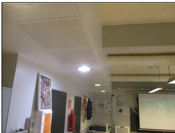
Kuva 5.18. Kuvaamataidon luokassa on osittain alaslaskettu katto ja osittain sisäkattona on selluloosakuitupinnoitteella päällystetty akustolevy
