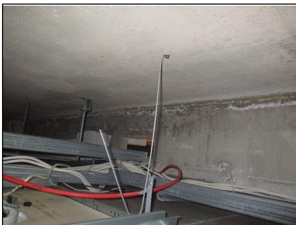
Kuva 5.13. Välipohjan ja seinän liittymässä kalkkihärmettä.
