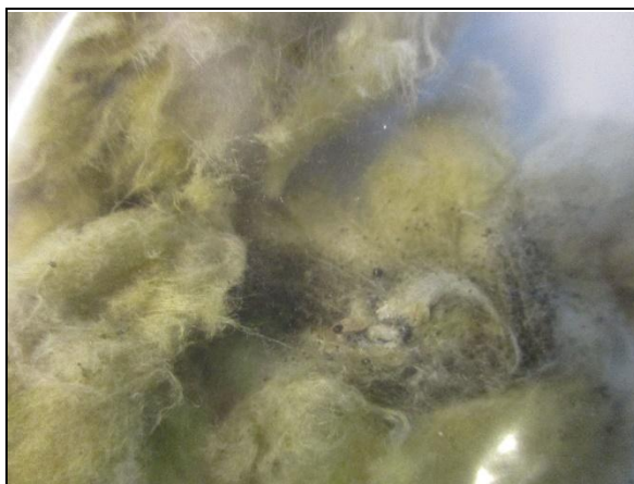
Kuva 5.11. Väliseinän villassa on vähäistä värinmuutosta.
