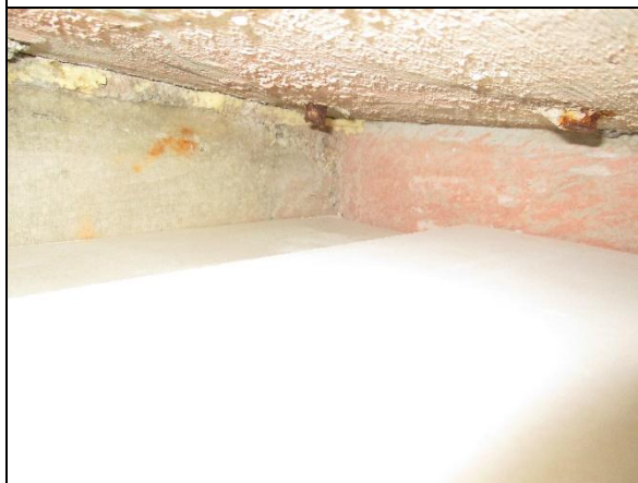
Kuva 5.17. Alakaton päällä betonirakenteen teräksissä korroosiota.
