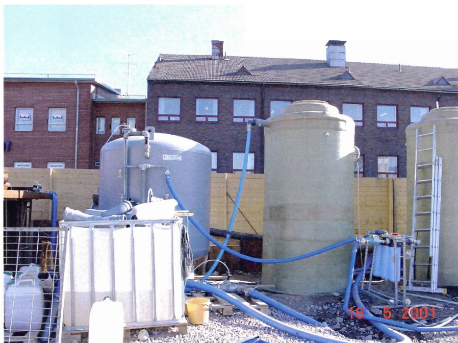
Hermannin liuotinpuhdistus, aktiivihiilisuodatuslaitteisto.
