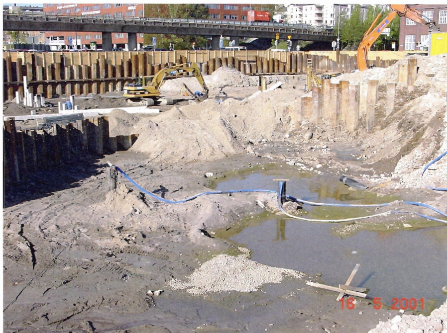
Hermannin liuotinpuhdistus, pumppausputkisto.
