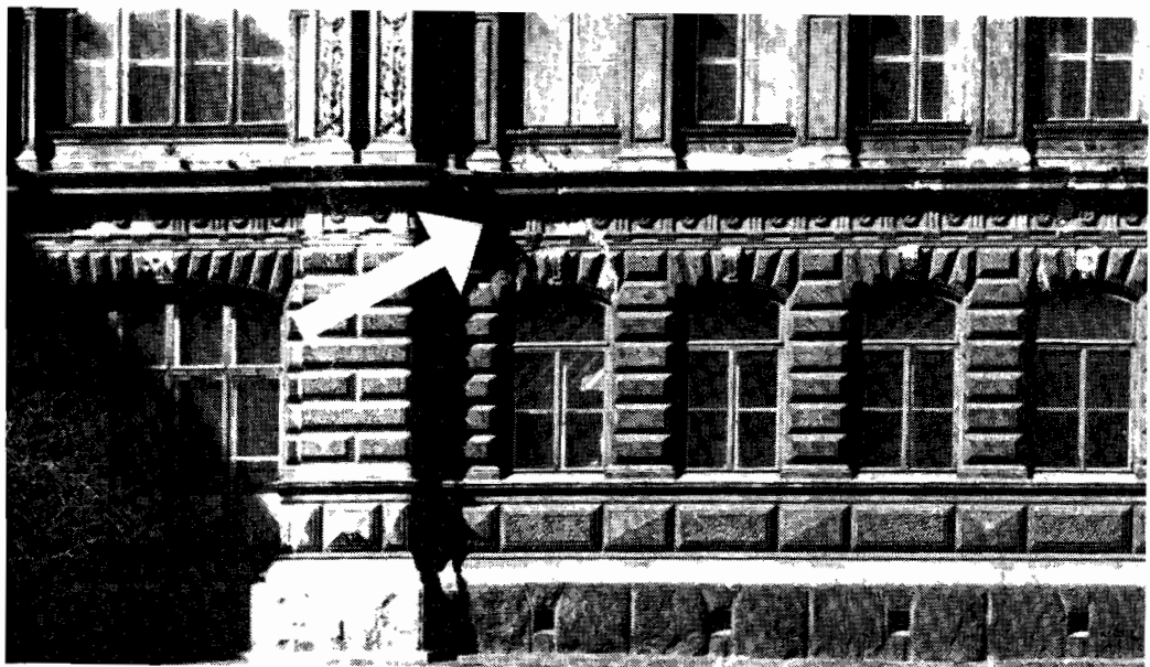
Kuva 29. Ateneum ehti painua ja halkeilla melkoisesti ennen vahvistamista. Jäljet ovat vielä näkyvissä
