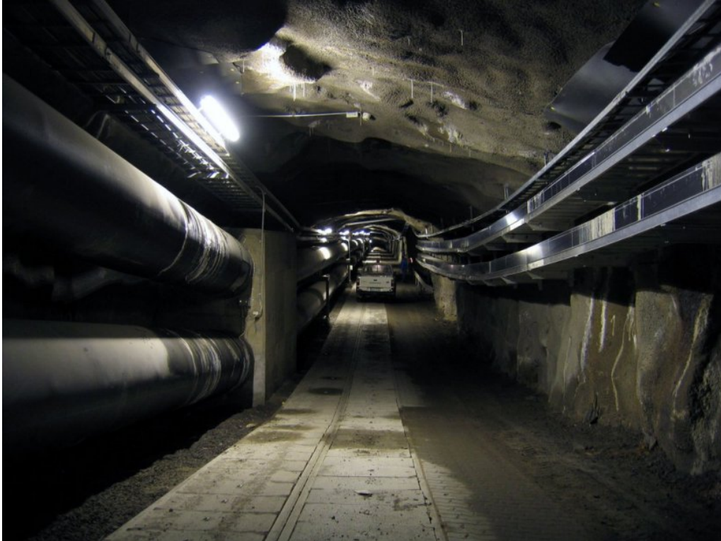
Kuva 22: Palo-osastoitu kaapeliarina oikealla ja palokatkona toimiva putkikannake vasemmalla (Jarkko Nyman, geotekninen osasto)
