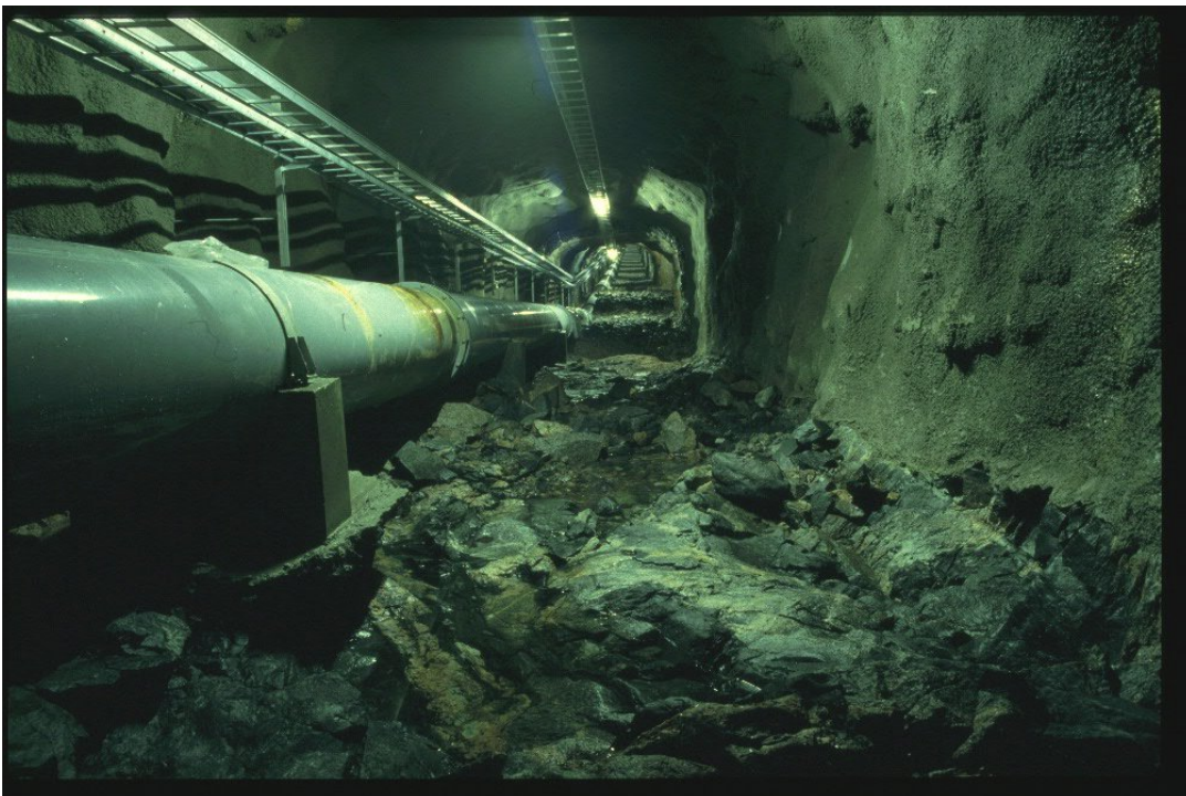
Kuva 29: Tulvan aiheuttamia vahinkoja Salmisaari – Kamppi – Ruskeasuo yhteiskäyttötunnelissa (Jorma Vilkmán, Helsingin Energia)
