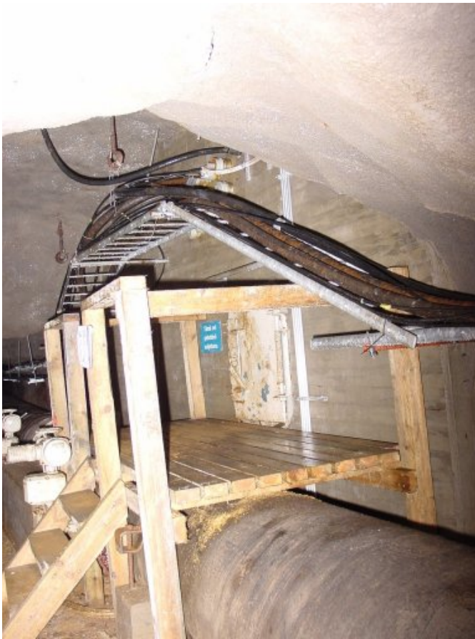
Kuva 30: Pasilan vesijohtotunneleiden ja Salmisaari – Kamppi – Ruskeasuo yhteiskäyttötunnelin välinen paineseinä ja henkilöluukku
