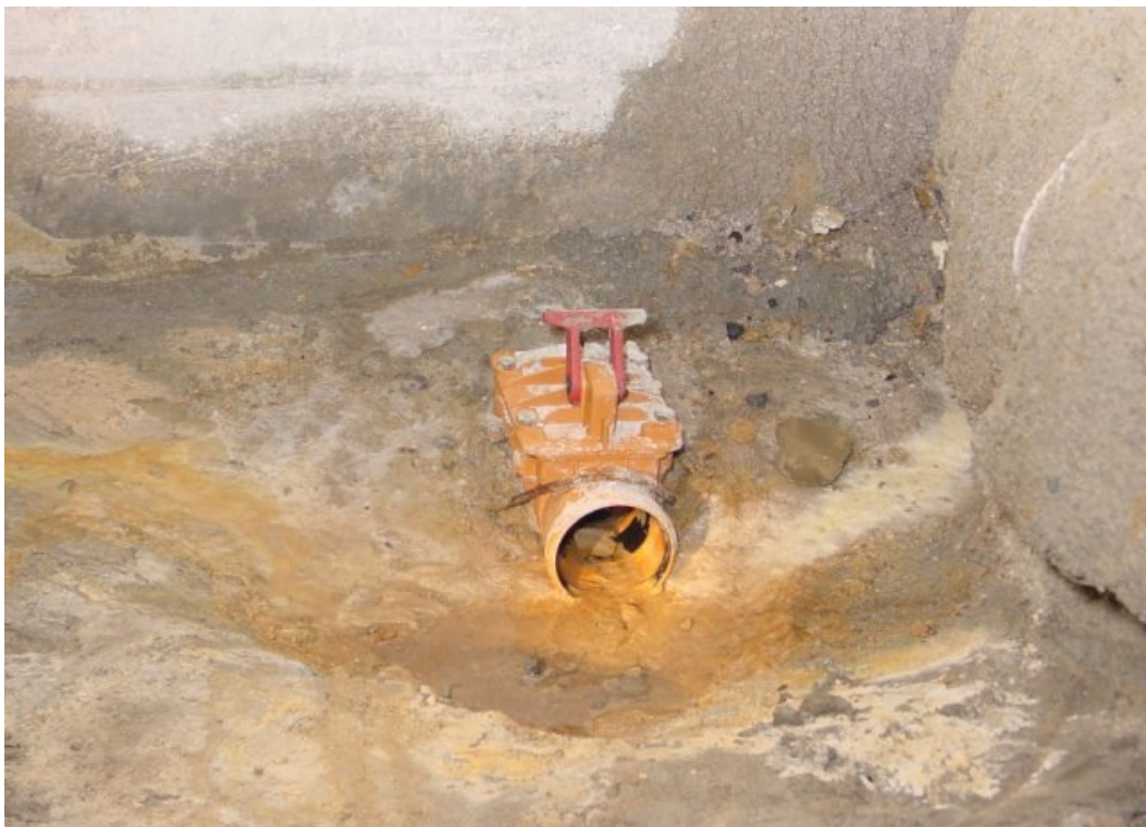
Kuva 34: Tulvaseinän läpi menevän vuotovesien poistoputken takaiskuventtiili
