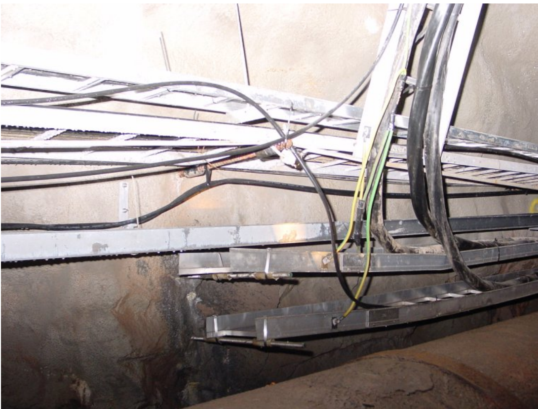
Kuva 3: Kaapeliarinoita Ilmala – Alppila vesijohtotunnelissa
