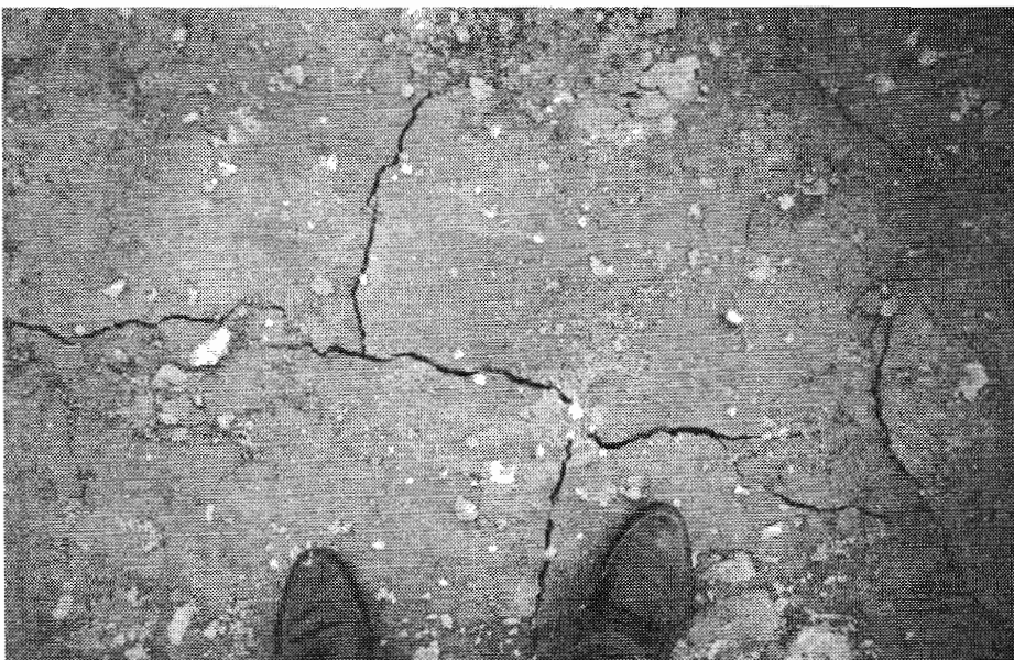
Kuva 15. Nopea kuivuminen aiheutti saven pinnassa verkkohalkeilua.
