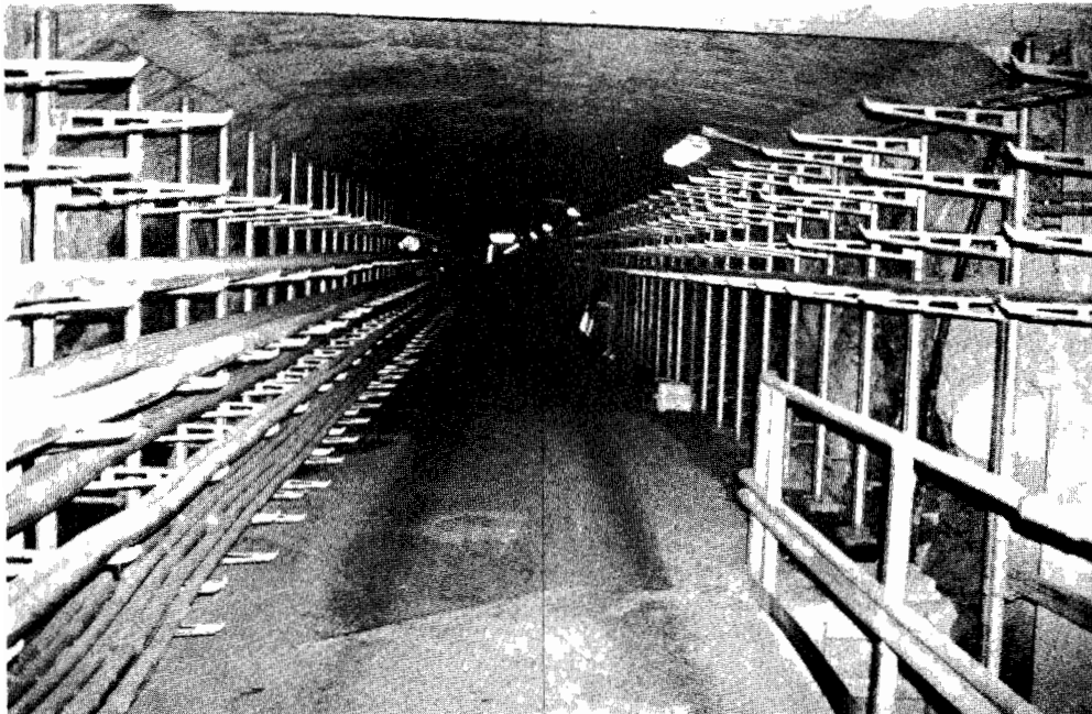
Kuva 12. Kaapeleita kaksikerroksisen tunnelin alakerrassa.
