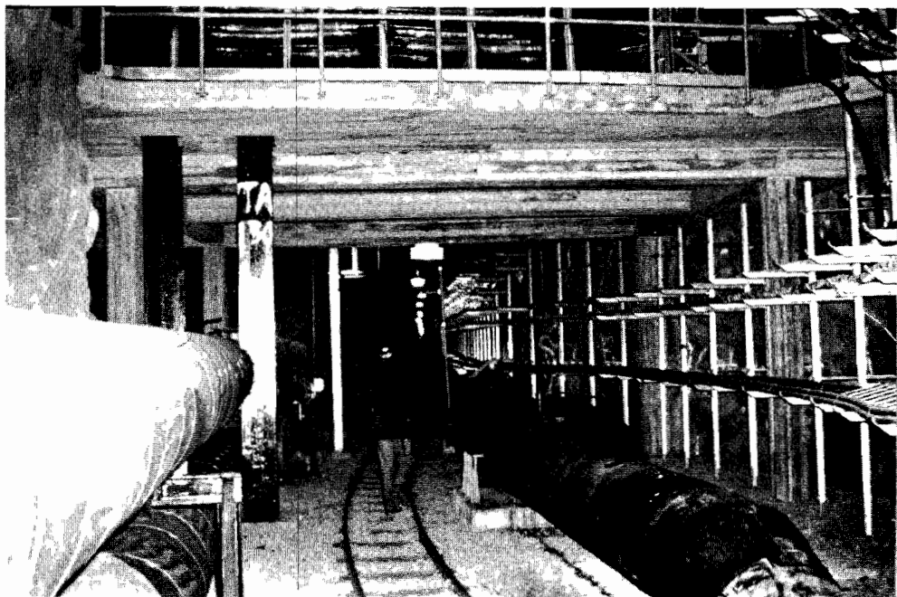
Kuva 2. Näkymä tunnelista erään kuilun kohdalla. Kaukolämpöjohdot lähtevät suoraan kuiluun, vesijohto kaartaa pohjan kautta ja kaapeli tunnelin yli rakennetun betonitasanteen kautta.
