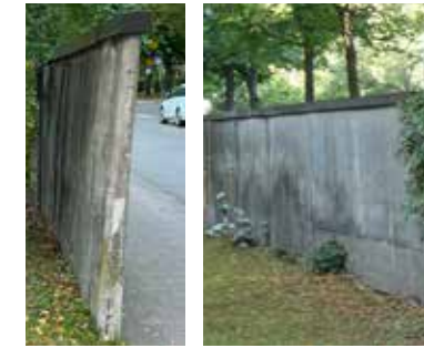
Gunnar Taucherin suunnittelema muuri vuodelta 1932. Paikalla valettu, raudoitettu betonimuuri. Kulttuurihistoriallista arvoa mutta muuri on huonokuntainen. Muurien aukot on ilmakuviin perusteella tehty 1980-luvulla sisäänkäyntirakennuksen yhteydessä.
