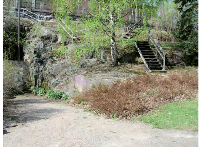
Rikkoontuneet puiset portaat poistetaan kokon- aan.
