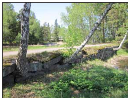
Tykkietien siltamuurirakenteessa kasvavat koivut
