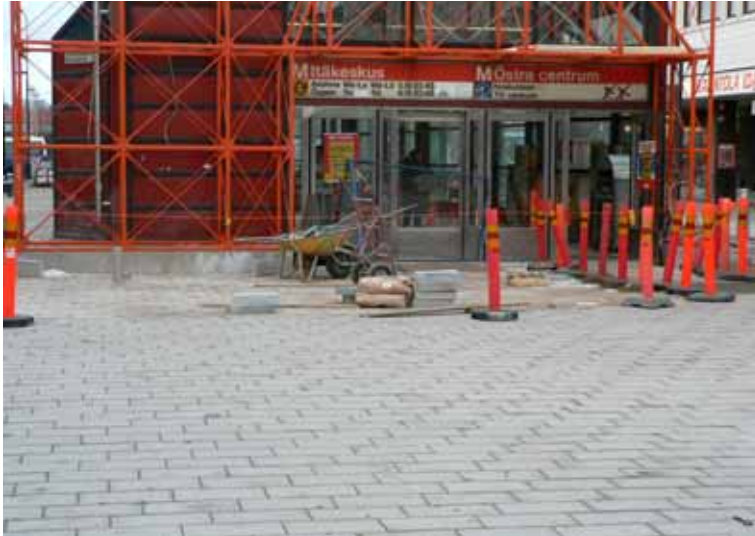
Kuva 27. Näkövammaisen ei erota sulkuköyttä.
