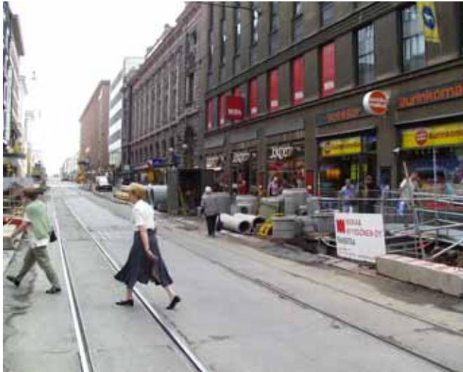
Kuva 24. Työmaan kevyen liikenteen ohjaus ei ole kunnossa /14/.
