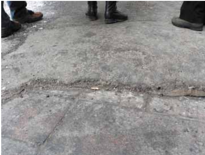
Kuva 42. Kylmässä valettu asfaltti lohkeilee helposti
