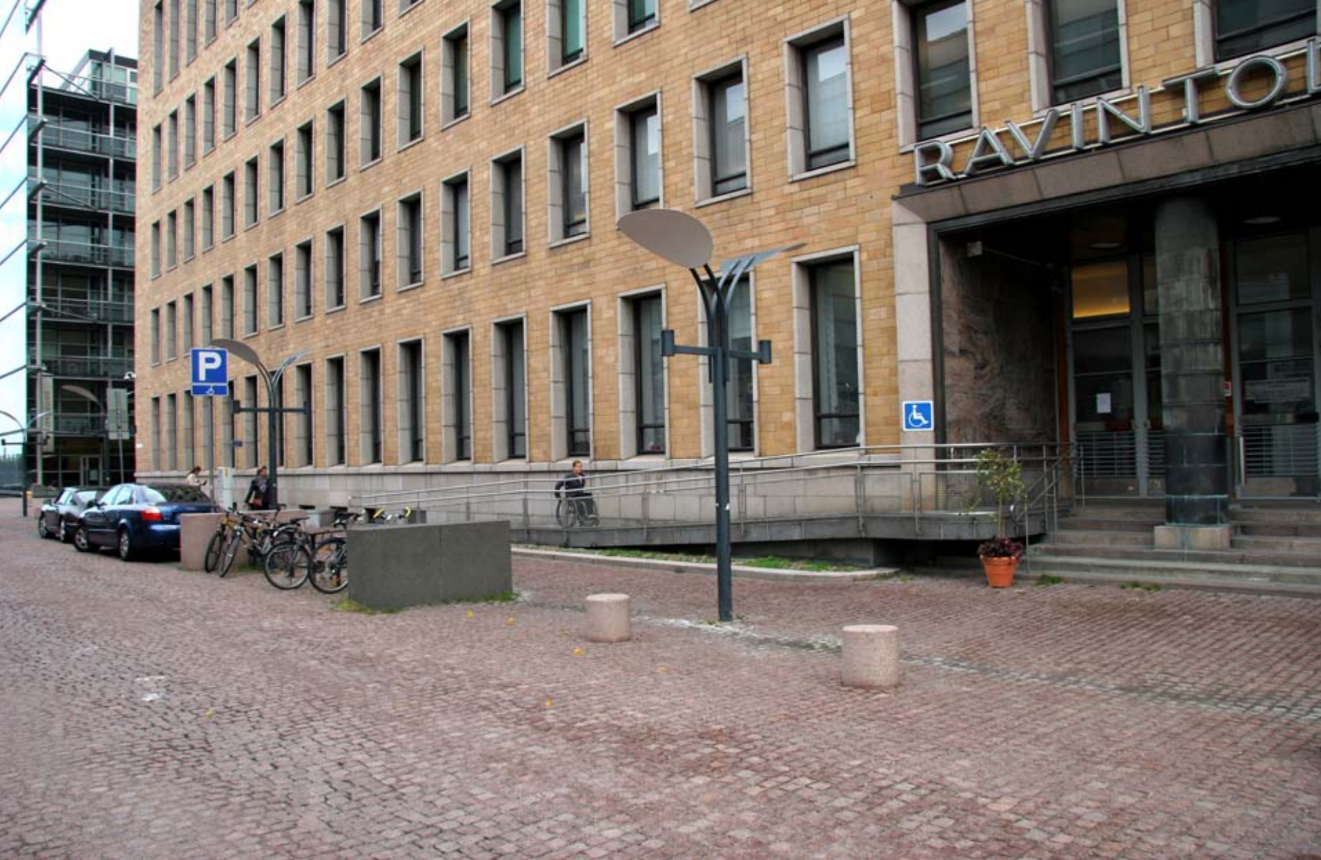
13. Sisäänkäynnin tasoeroon on rakennettu jälkeinpäin luiska. Oikein mitoitettu luiska vie paljon tilaa. (Postitalo)
