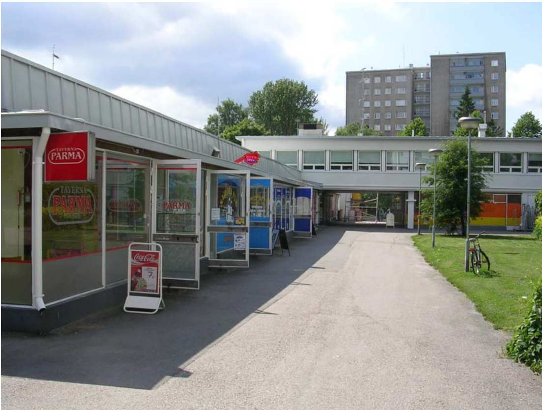
Kuva 21. Pohjois-Haagan ostoskeskuksen kaikissa sisäänkäynneissä on liikkumista haittaavat kynnykset.
