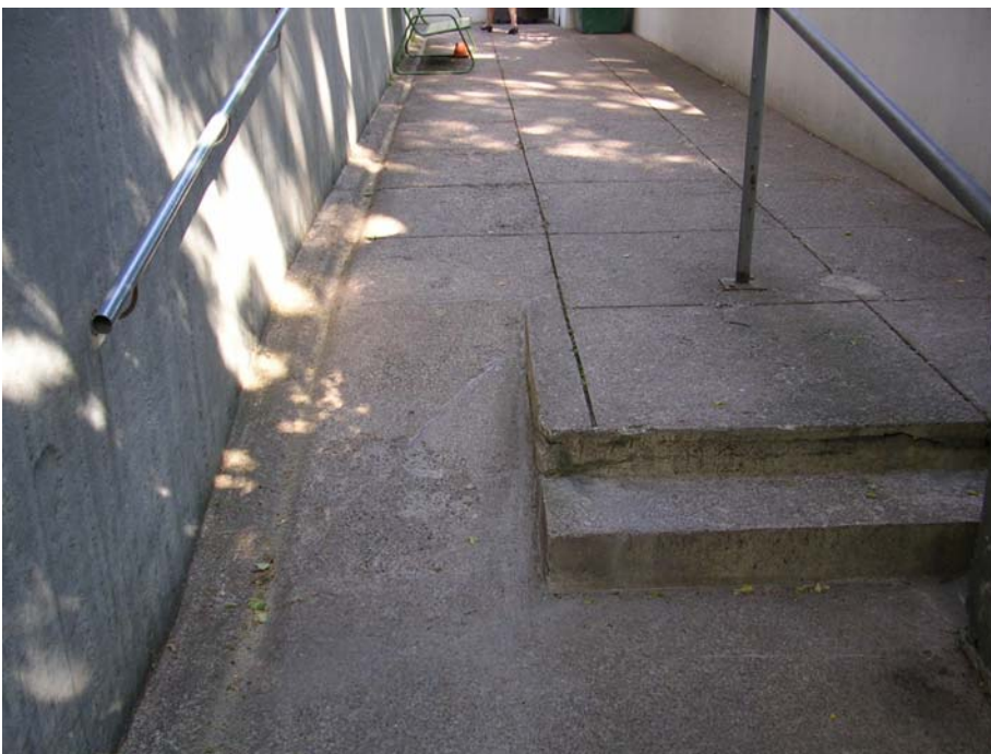
Kuva 1. Sankaritie 1:ssä sijaitsevan Bertahemmetin vanhusten palvelutalon pihaan johtava käytävä ja sisäänkäyntien luiskat ja portaat eivät täytä esteettömyyden vaatimuksia.
