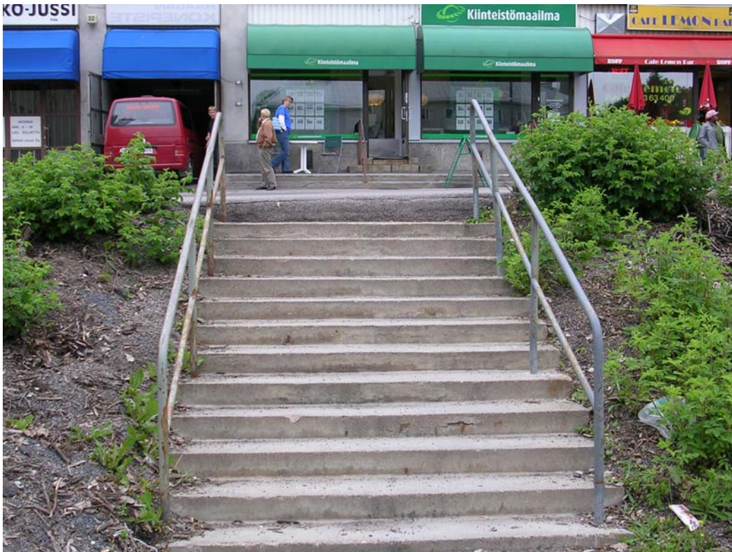
Kuva 11. Haagan torin yleisilme on erittäin vaatimaton ja alue kaipaa kokonaisvaltaista kehittämistä. Porrasyhteydet Kauppalantielle eivät täytä esteettömyyden vaatimuksia.
