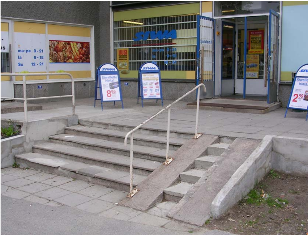
Kuva 13. Useiden kiinteistöjen alueiden järjestelyt eivät täytä esteettömyyden vaatimuksia. Myös rakenteiden kunnossapidossa on parantamisen varaa (Kauppalantie 23).
