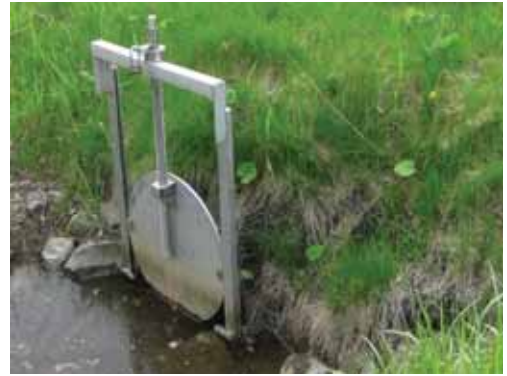
Tulvasuojauksiin liittyvä sulkuportti Vanhanväylän puistossa.
