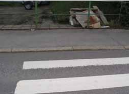
Suojatien kohdalla jalkakäytävän reunakiven tulisi olla luiskattu..
