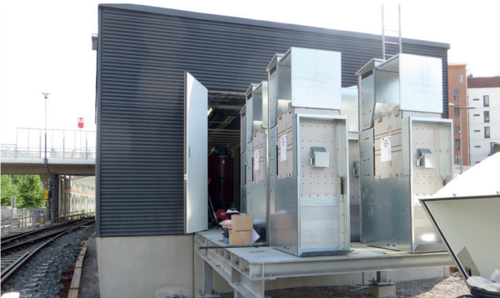
Metron sähkönsyöttöasema Vuosaarella.
