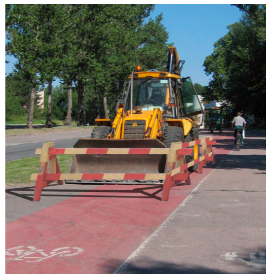
Bild 2. Skyddandet av arbetsmaskiner får inte leda till att fotgängarna måste röra sig ute på körbanan.
