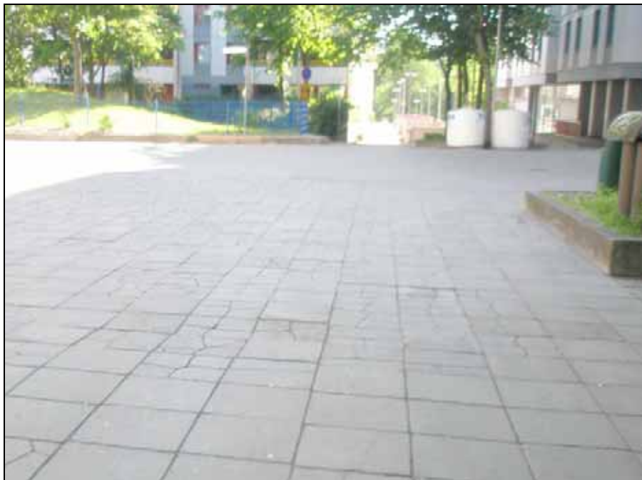
Kuva 23. Itä-Pasilalle tyypillinen laatoitus on useilla väyläosuuksilla ja aukioilla halkeillut ja epätasainen.
