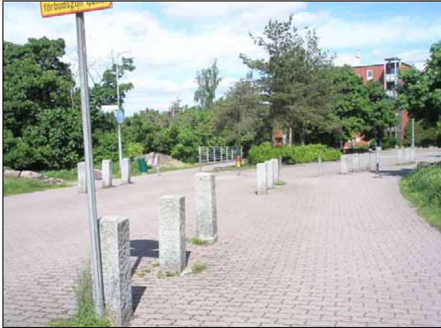
Kuva 15. Metallisten pollareiden huomioteippaukset tulee uusia ja pollaririvistöjen kohdille tulee asentaa kummallekin puolelle 600 mm leveä varoitusalue mustista lohkopintaisista noppakivistä, Länsi- ja Keski-Pasilan toimenpidekartan kohta 2.
