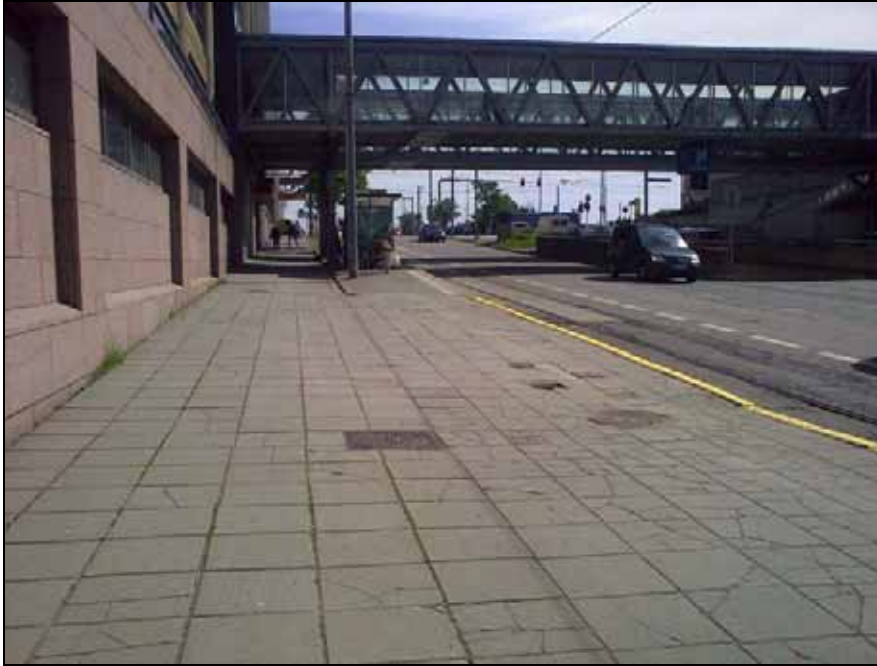
Kuva 38. Ratapihantiellä betonilaatoitus on halkeillut ja epätasainen ja se tulee vaihtaa muun katujakson kanssa yhdenmukaiseksi betonikiveykseksi, Itä-Pasilan toimenpidekartan kohta 3.
