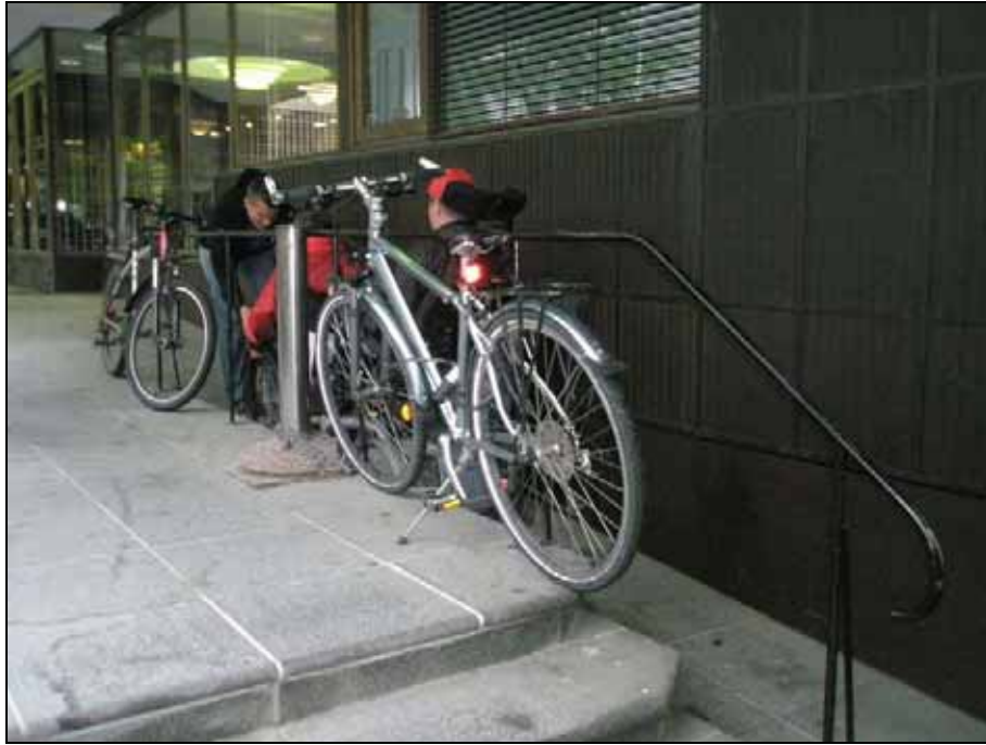
Kuva 31. Kirjaston sisäänkäynnin portaiden käsijohte ei ulotu viereisen luiskan loppuun asti luiskan yläpäässä. Käsijohteeseen lukitut pyörät estävät käsijohteen käytön.
