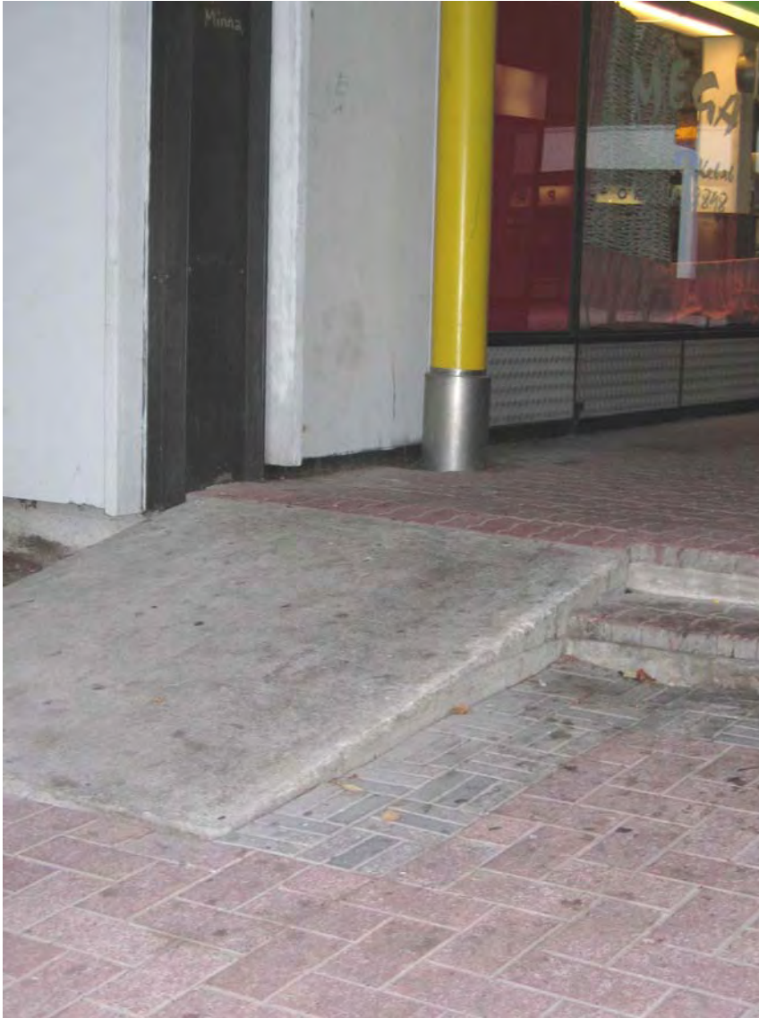
Kuva 8. Ostoskeskuksen luiska on liian jyrkkä ja siitä puuttuu käsijohteet sekä suoja-reunus.
