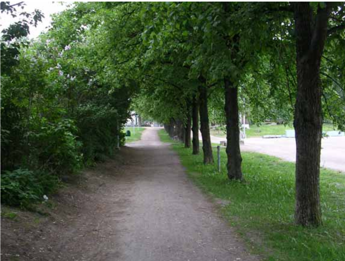
Kuva 30. Huopalahdentie ylikulkusillalle johtava puistokäytävä on pahasti painunut. Munkkiniemen toimenpidekartan kohta 9.
