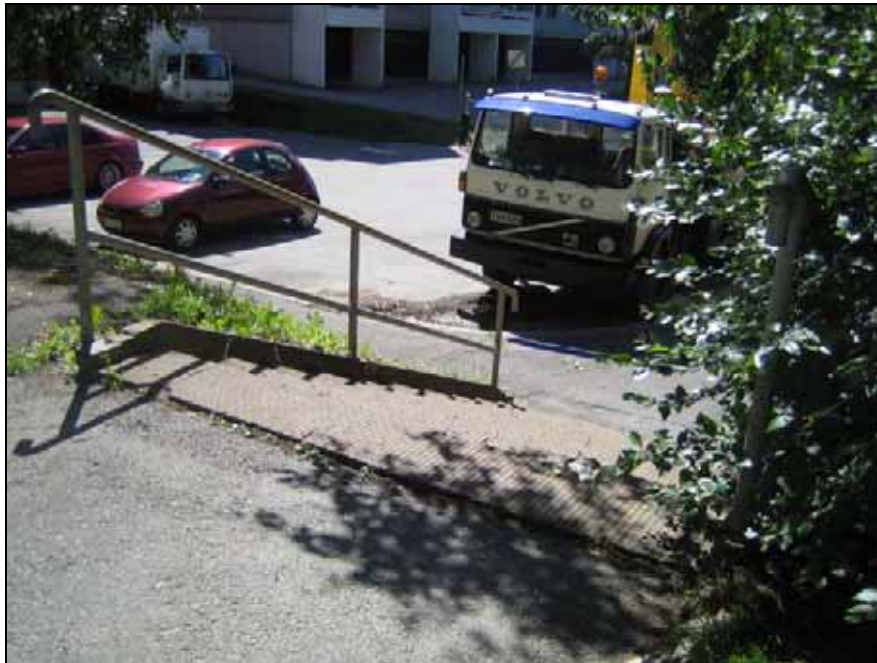
Kuva 21. Korvatunturinpolun ja Ounasvaarankujan välillä olevat portaat käsijohteineen tulee rakentaa uudelleen SuRaKu-ohjekortin 3 (tasoterot) perustason ratkaisun mukaisesti, toimenpidekartan kohta 6.
