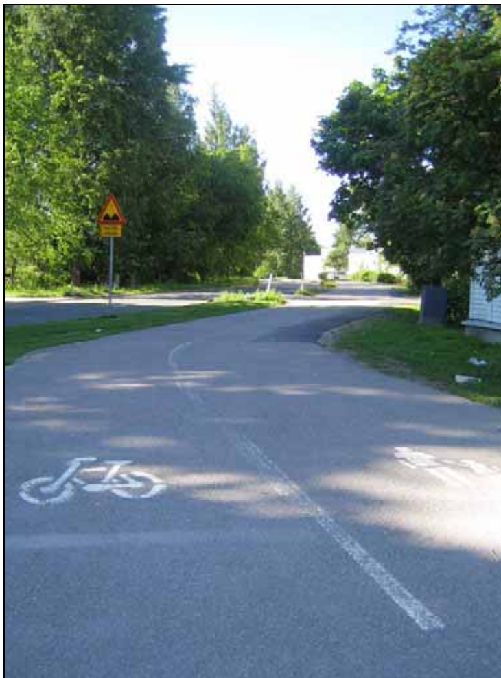
Kuva 15. Naulakalliontien huonokuntoinen jalankulku- ja pyörätien välinen erotteluraita tulee uusia massaamalla, toimenpidekartan kohta 1.
