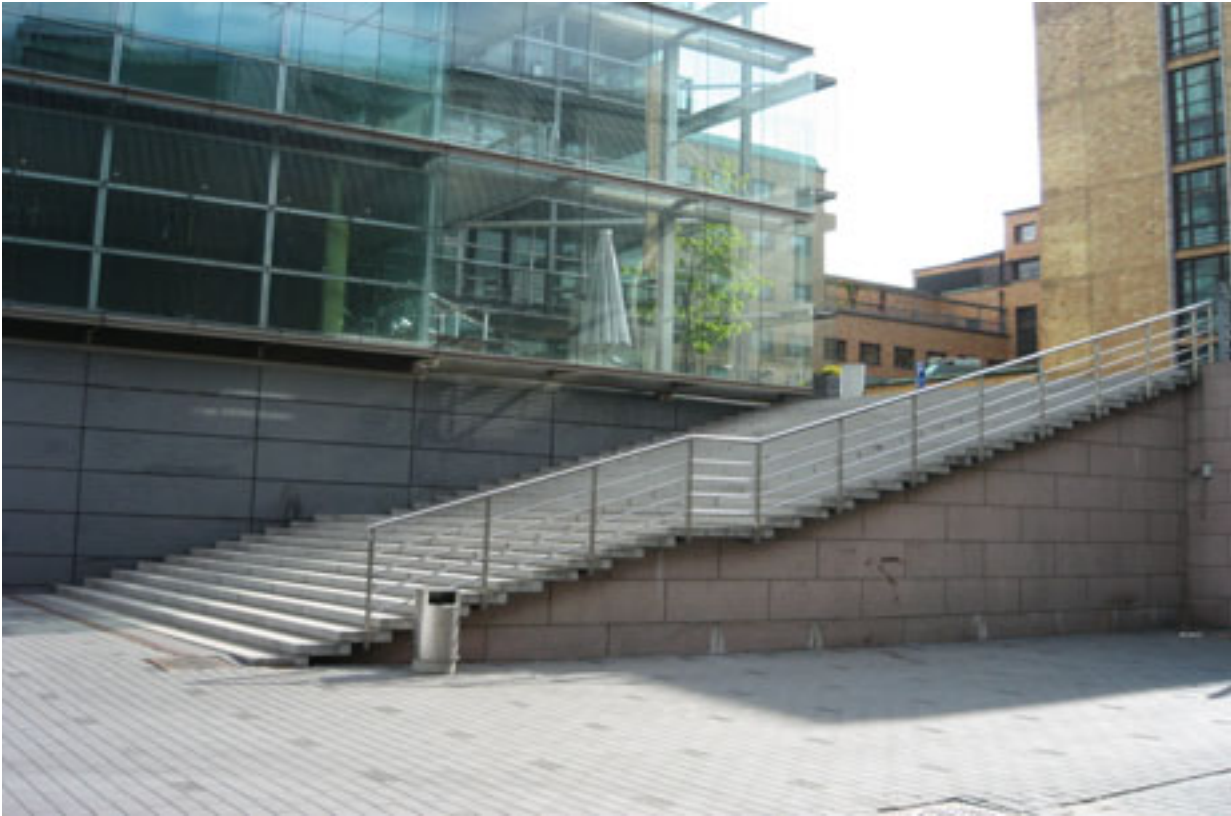
Kuva 52. Sanomatalon ja Kiasman välisten portaiden käsijohteet eivät täytä vaatimuksia ja puuttuvat toiselta puolelta kokonaan.
