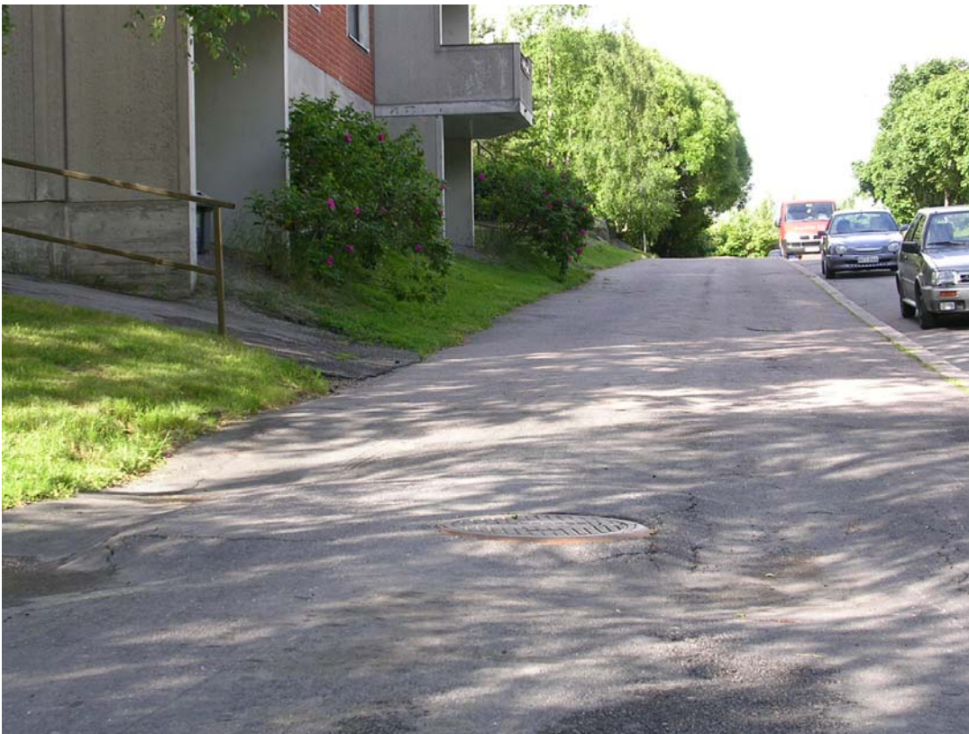
Kuva 18. Vetelintien itäosan eteläpuoleisen jalkakäytävän päällyste on pahasti painunut ja siinä on syviä, kaatumisvaaran aiheuttavia kuoppia.
