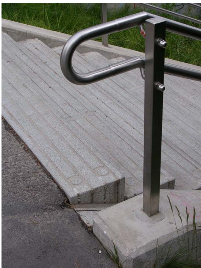
Kuva 31. Asemalta Soittajantielle laskevissa portaissa heikkonäköisen on vaikea tunnistaa askelmien reunoja. Parannustoimenpiteenä on kontrastiraidan lisääminen graniittiportaaseen.
