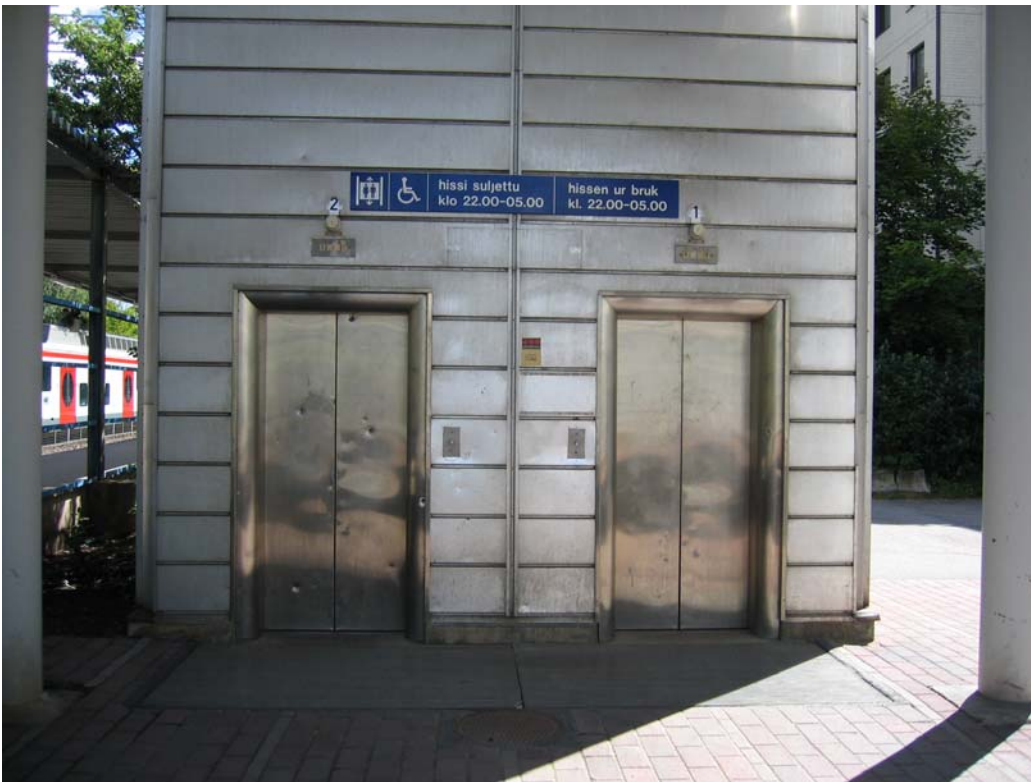
Kuva 24. Hissien sulkeminen yöajaksi, niiden epäsiisteys sekä ovien ja painonappien huono erottuminen seinäpinnasta ovat ongelmia Kannelmäen asemalla.
