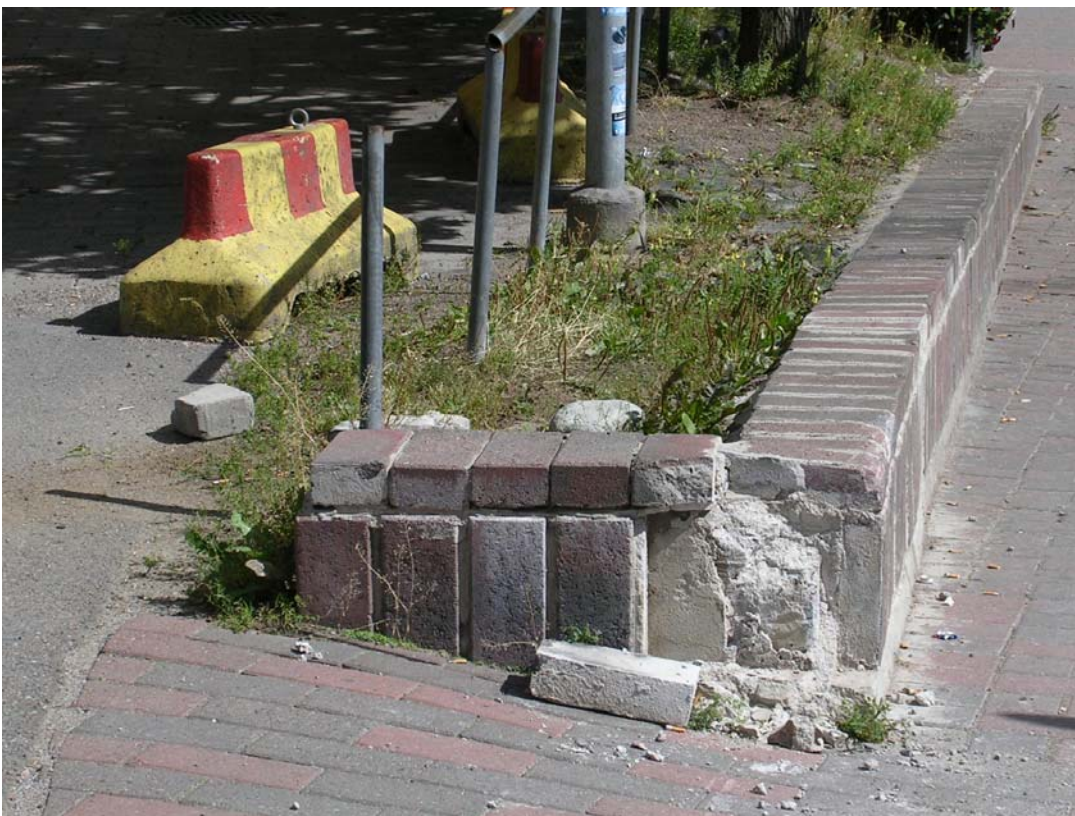
Kuva 23. Rikkinäiset rakenteet tekevät Malminkartanon aukiosta epäsiistin ja esteisen.
