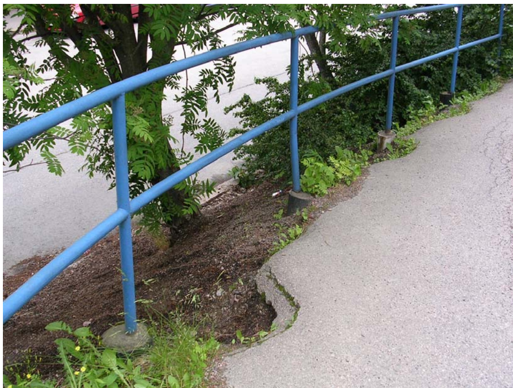
Kuva 10. Aseman ja terveysaseman välisen luiskan reuna on pettänyt ja asfaltti on murtunut vaarallisesti. Käsijohteet pitäisi olla molemmin puolin väylää.
