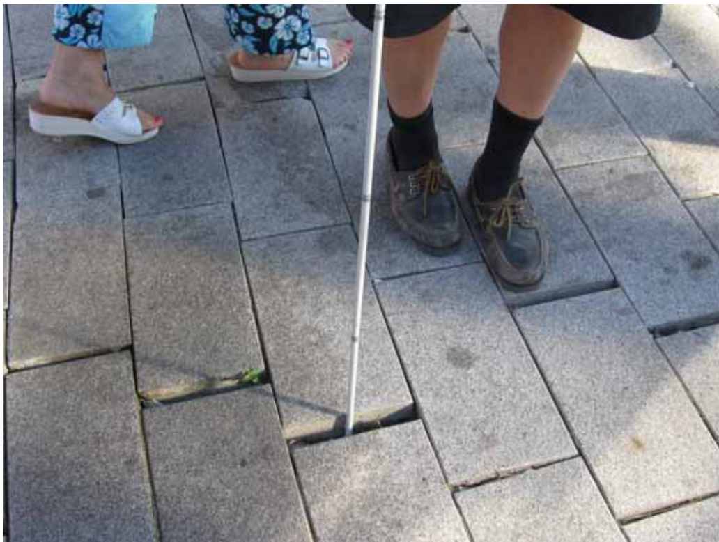
Kuva 24. Tallinnanaukion päällystekivien liikkuminen on johtanut leveiden ja syvien kolojen syntymiseen laattojen saumoissa.
