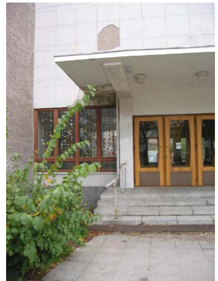
Pääsisäntulo Mäkeläkadulle. Julkisivun maali ei sovi rappausalustaan
