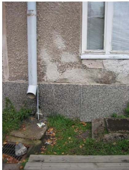
Julkisivun ja sokkelin kosteusvaurio
