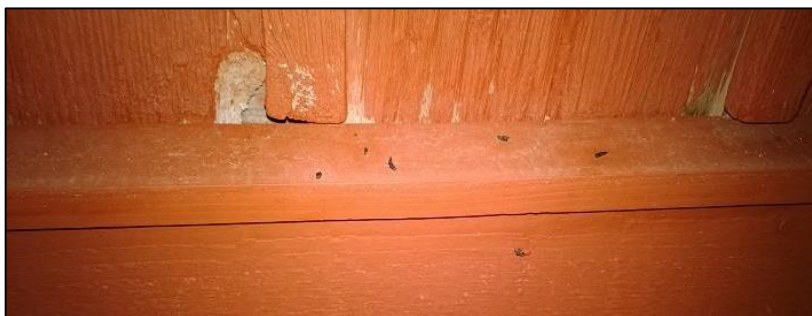
Kuva 7. Lepakon ulostetta Kaivoshuvilan seinälaudoituksen alapuolella.
