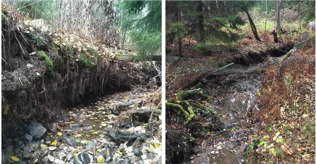
Kuva 9. Ramsinkannaksenpuron erodoitunutta yläjuoksua uomaosuudella 1.
