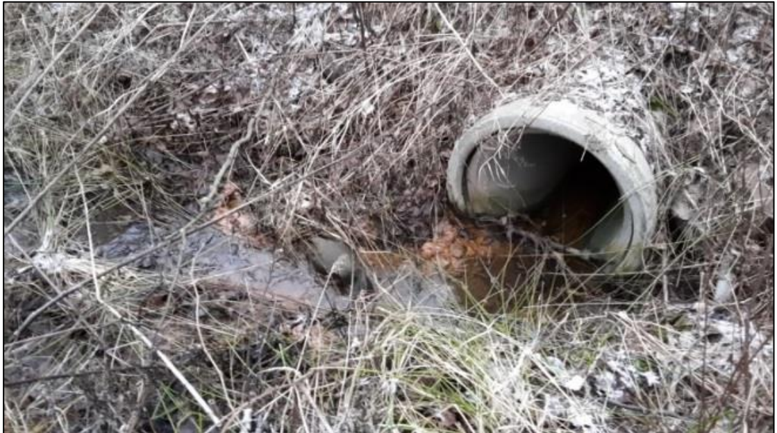
Kuva 10. Viilarintien 1000B viemäriin liittyvän 500B viemärin suu.
