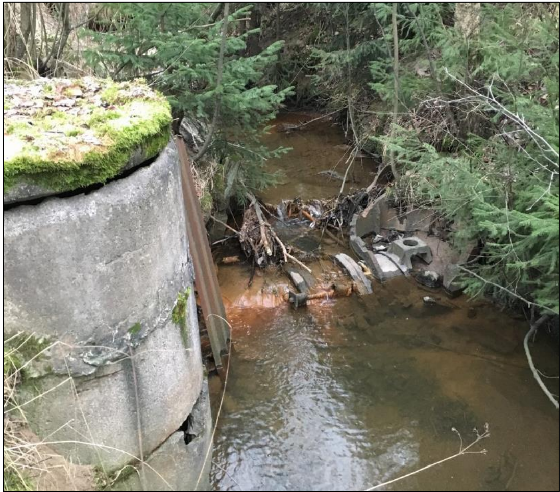
Kuva 14. Käytöstä poistettu vesijohto purku-uomassa.
