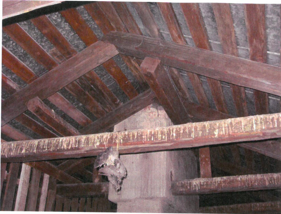
Kuva 15. Kuvassa galvanoitu kate ja tilan ullakkotilan muu tilanne. Aluskate puuttuu. Kondenssiriski on ilmeinen.
