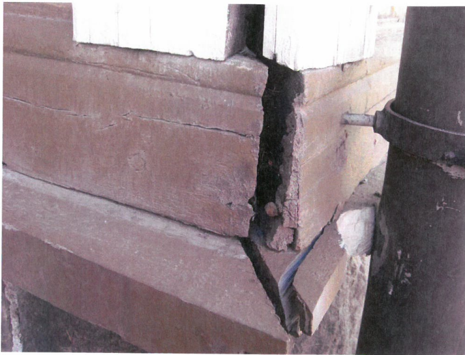
Kuva 13. Kadunpuolella on puurakenteiden liitoksissa vaurioita. Lahovauriot todennäköisiä.
