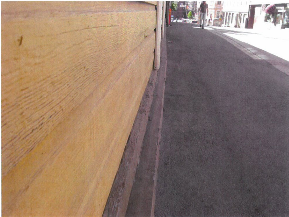
Kuva 3. Varastorakennuksen rakenteet ovat taipuneet kadulle päin.
