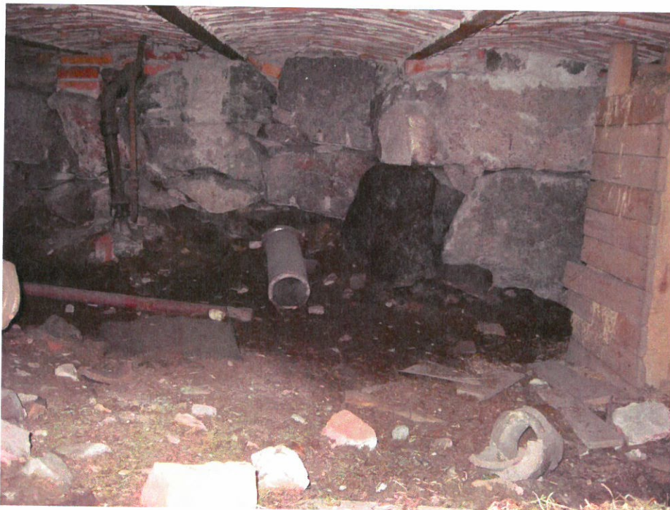
Kuva 12. Kellaritilat holvattu tiili-/l-palkkeja kiviperustalla. Runsaasti eloperäistä materiaalia ja kosteutta. Tilaan ei päästy, kuva kissaluukusta.
