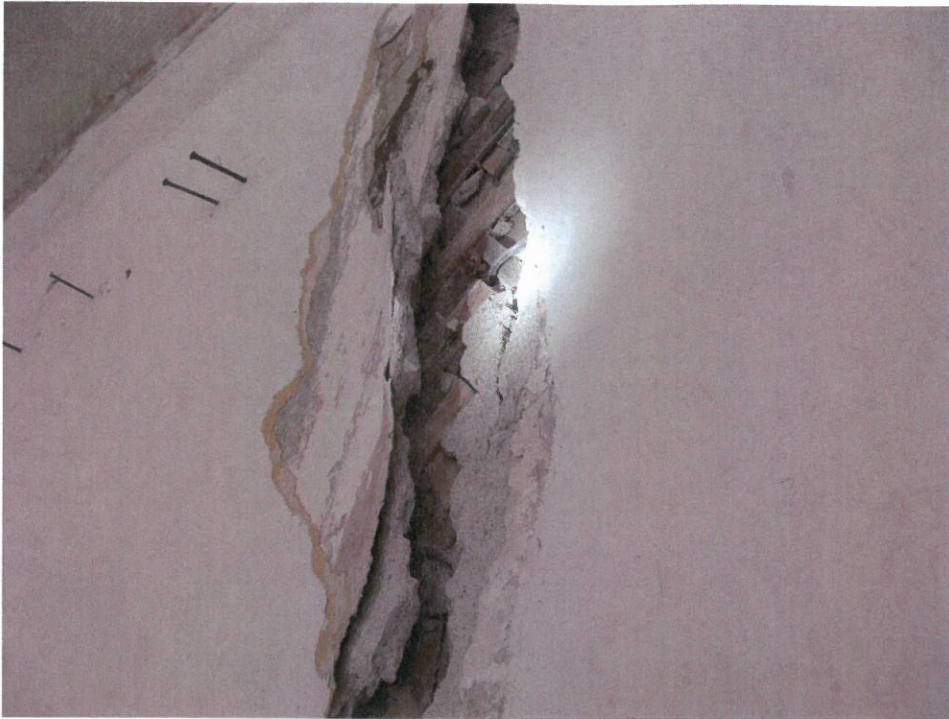
Kuva 7. Sisäseinien tikkurapatut seinärakenteet ovat irti alustastaan monin paikoin.
