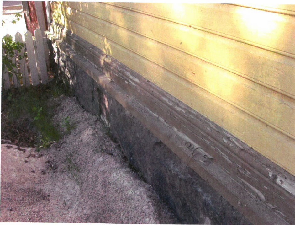
Kuva 16. Julkisivut ovat paikoin heikkokuntoisia. Osa julkisivupaneeleista on uusittu, esim. tuulikaapissa.
