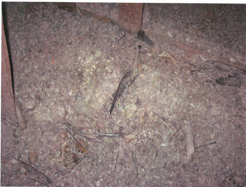
Kuva 14. Ullakko on lintujen jätöksissä ja myös raatoja on tilassa. Tilaa ei tarkastettu terveysriskin takia. Tarkastus edellyttää suojavarusteita.
