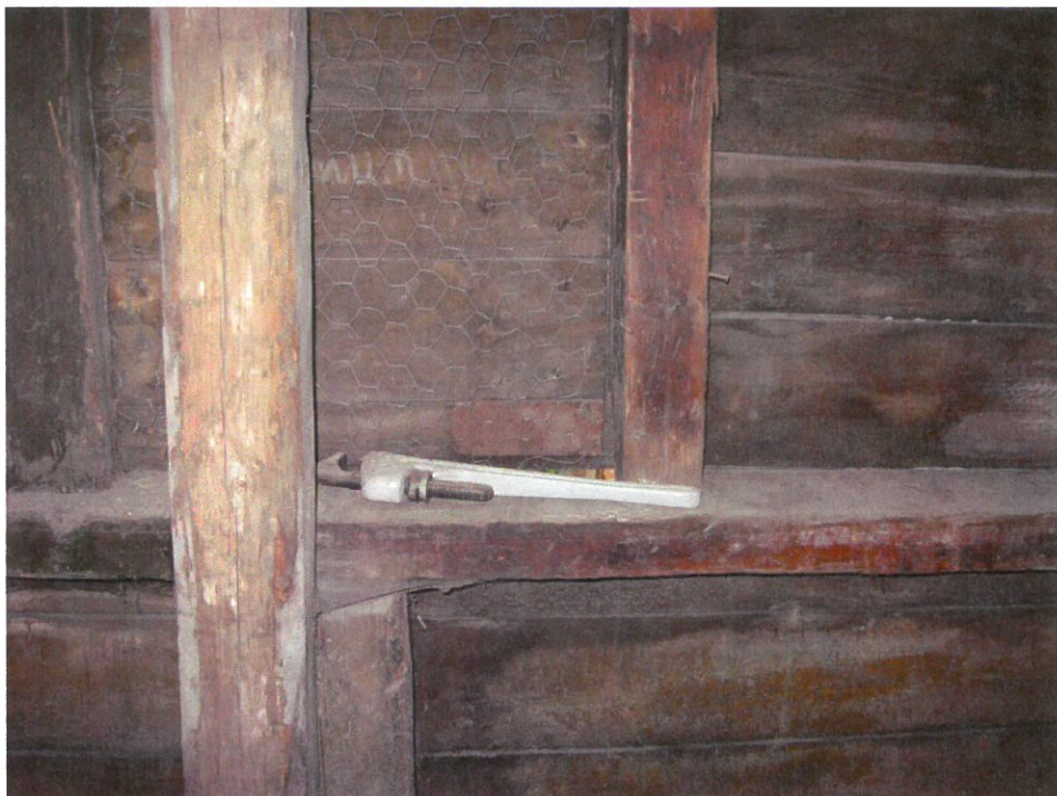
Kuva 4. Ristikkäisissä sisäkulmissa oli kosteusvaurion jättämiä jälkiä sekä viitteitä pintahomeesta.
