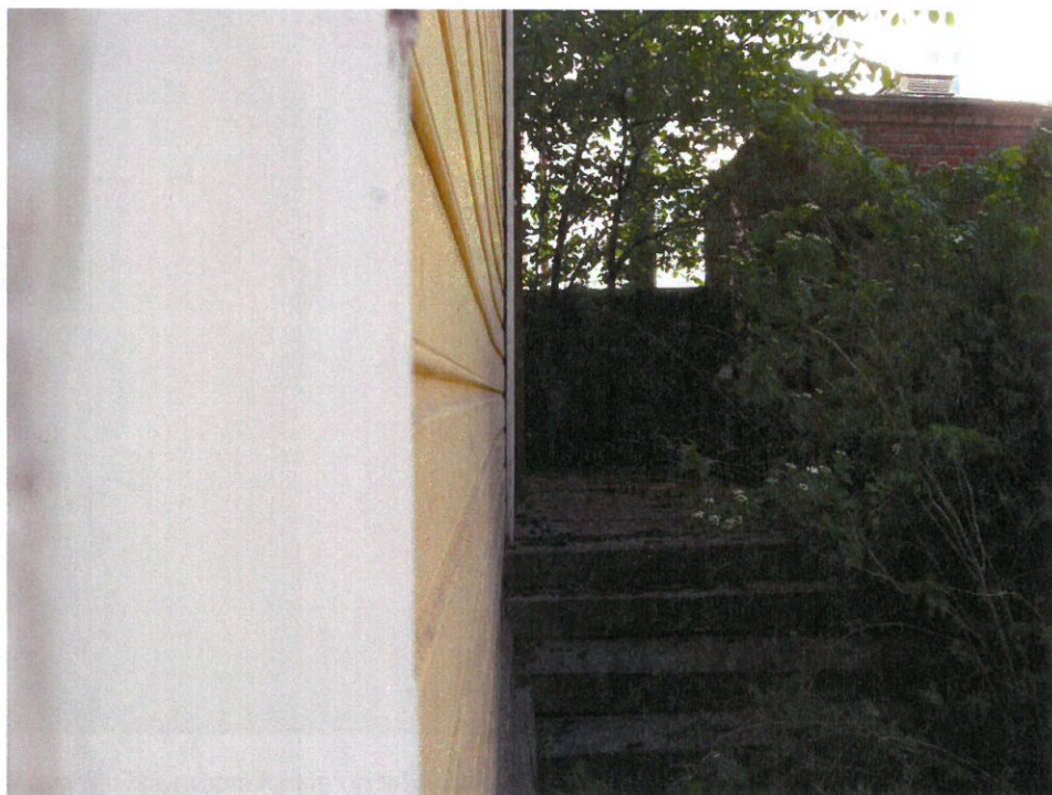
Kuva 6. Asuinrakennuksen toinen pääty on taipunut keskeltä ulospäin.
