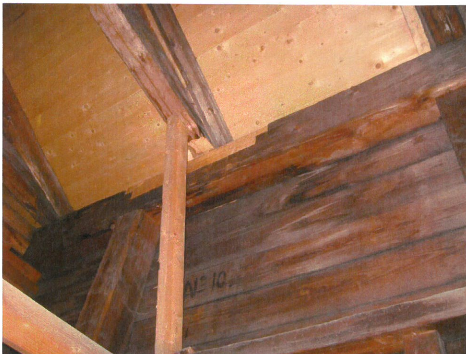
Kuva 1. Uusittuja kattokannattajia alapaarteiden tuenta puutteellinen.
