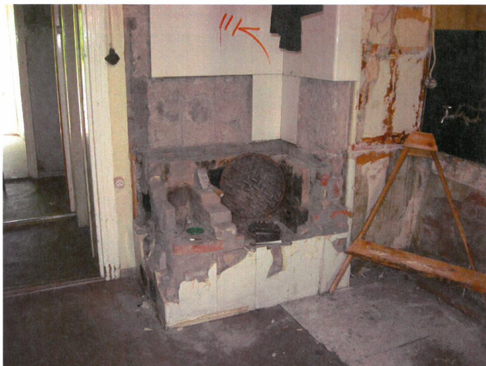
Kuva 10. Tulisijat osin tuhottu kokonaan, vähintään luukut on varastettu. Lattiat liesien edustoilla on betonoidut ja osin kovalevyypintaisia.
