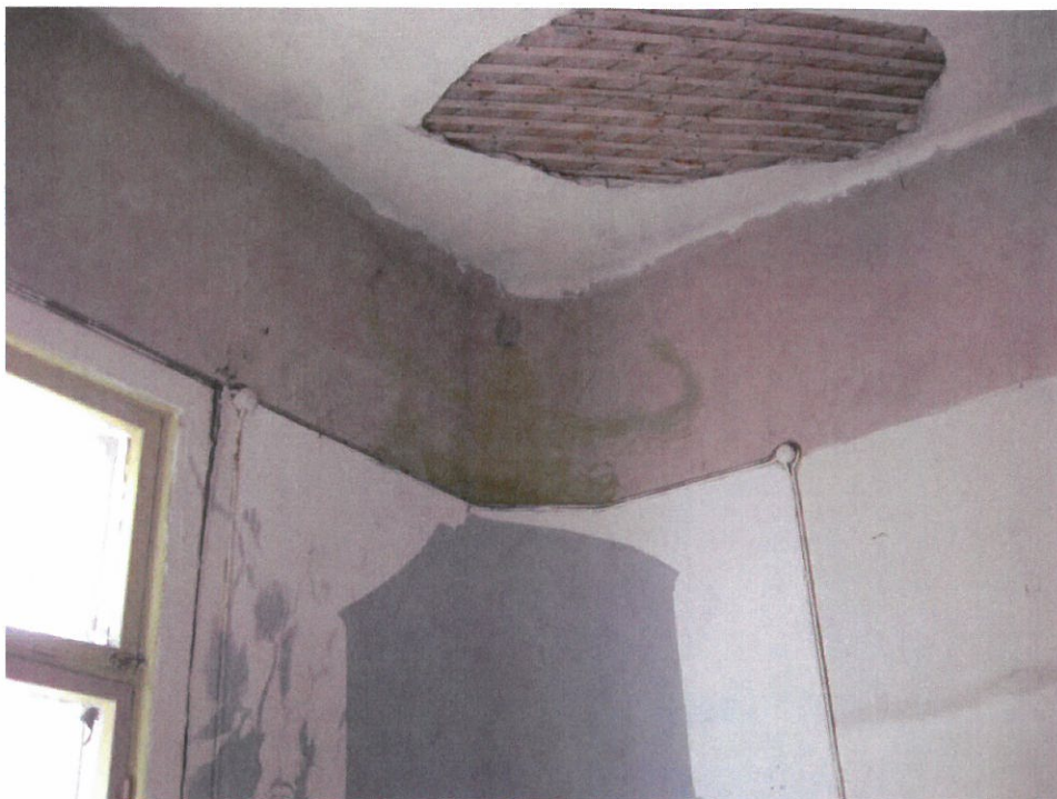
Kuva 9. Kattorappaukset ja seinärappaukset ovat paikoin irti alustastaan.
