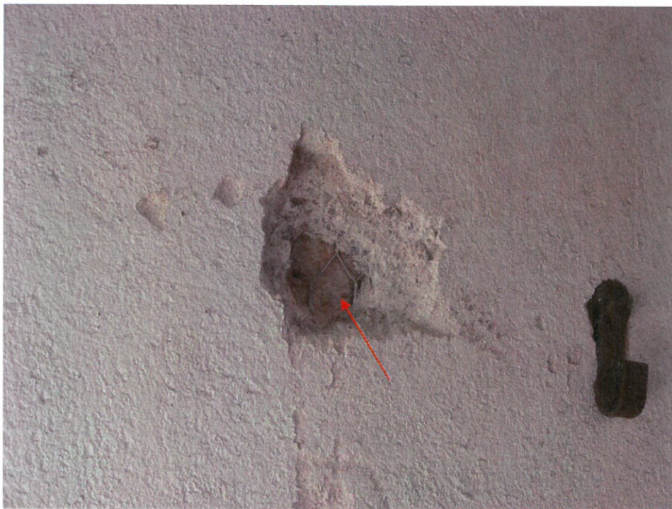
Kuva 8. Osa rappauksista on tehty jälkeinpäin verkkorappauksena.
