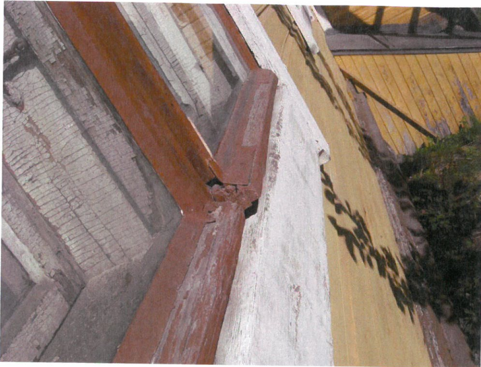
Kuva 11. Osa ikkunoista on mahdollisesti alkuperäisiä, kunto niissä heikko. Vaihdetut ikkunat ovat paikoin myös heikkokuntoisia. Alkuperäistä jäljittelevät pintahelat puuttuvat.
