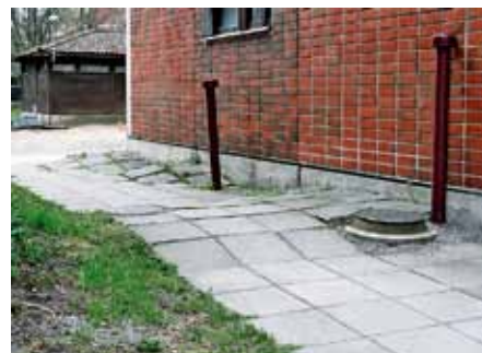
18. Maan painumisen aiheuttamia vaurioita raitin pohjoispäässä.
