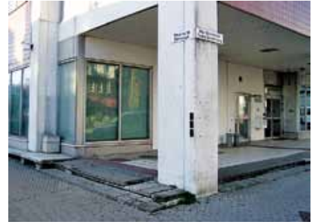
24. Malmin virastotalon sisäänkäynti on huonossa kunnossa.
