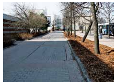
8. Maanpinnan painuminen on synnyttänyt raitille vaarallisia kuoppia sekä kallistanut puita ja valaisimia.
