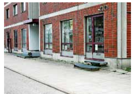
5. Maan painuminen on aiheuttanut ongelmia rakennusten sisäänkäynneillä.
