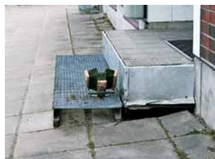
17. Maanpinnan painuminen on jättänyt rakennusten sisäänkäyntiportaita tyhjän päälle.
