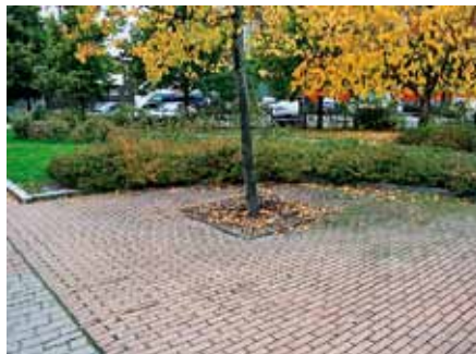
34. Osa raitin puiden juuriritoista rajautuu suoraan betonikiveykseen.
