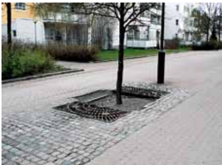
33. Osa Pekanraitin puiden juuriritoista on kokonaan ympäröity graniittinoppakivillä. Juuriritilät ovat paikoin vaurioituneet ja puilta puuttuu runkosuojat.
