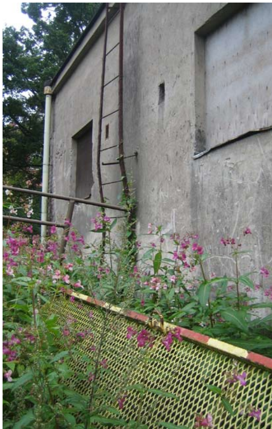
Rakennuksen kunnossapito on laiminlyöty.
