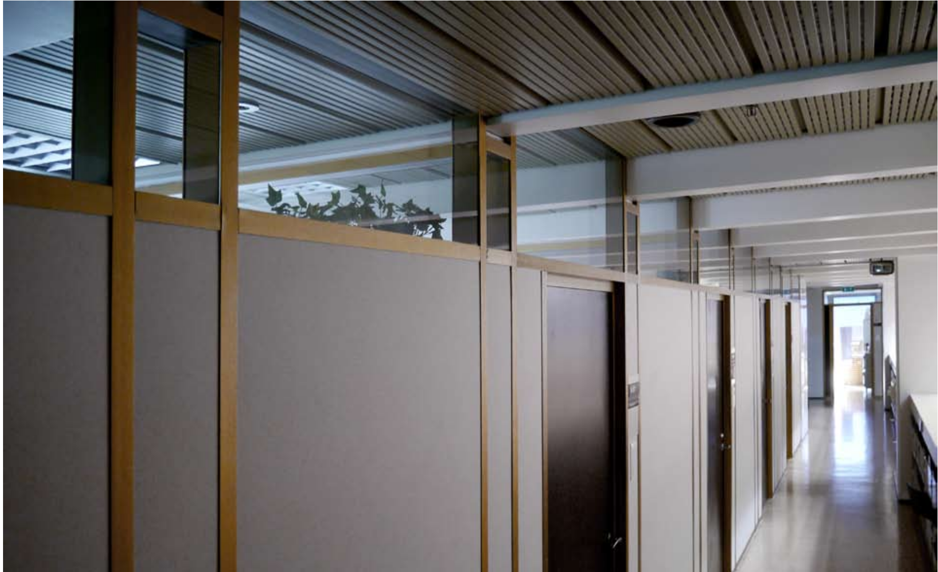
↑ Näkymä A-tornin 5. kerroksesta. Toimistotilat on toteutettu alkuperäisellä väliseinäjärjestelmällä. Alakatot jatkuvat yhtenäisinä käytäviltä toimistotiloihin. amoy 2013
