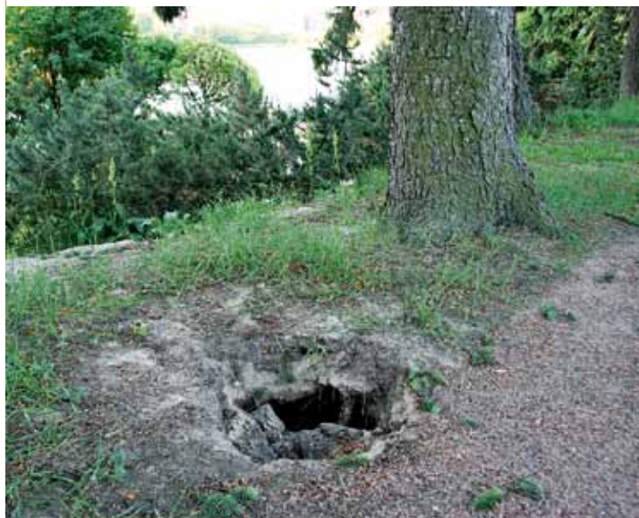
Kuva 33. Ison puun tyvellä oleva kanien käytävän suuaukko on sortunut Hietaniemen hautausmaalla.
